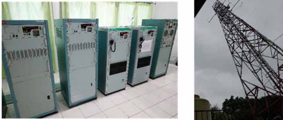
第 4.1.2 -3 写真 送信局機器及び空中線鉄塔
