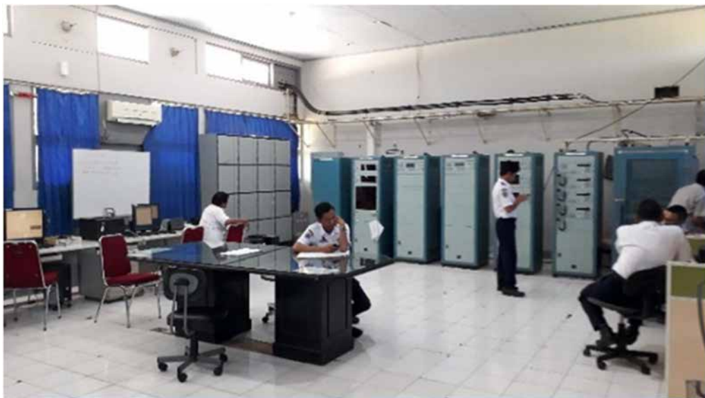
第 4. 1. 7 -3 写真 GMDSS 運用室
