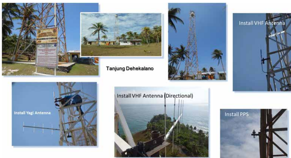
第 5.8 -1 写真 AIS 受信装置設置状況
