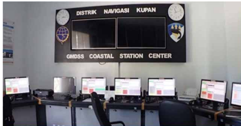
第 4.1.1 -2 写真 クパン管区航路標識事務所の GMDSS 運用室
