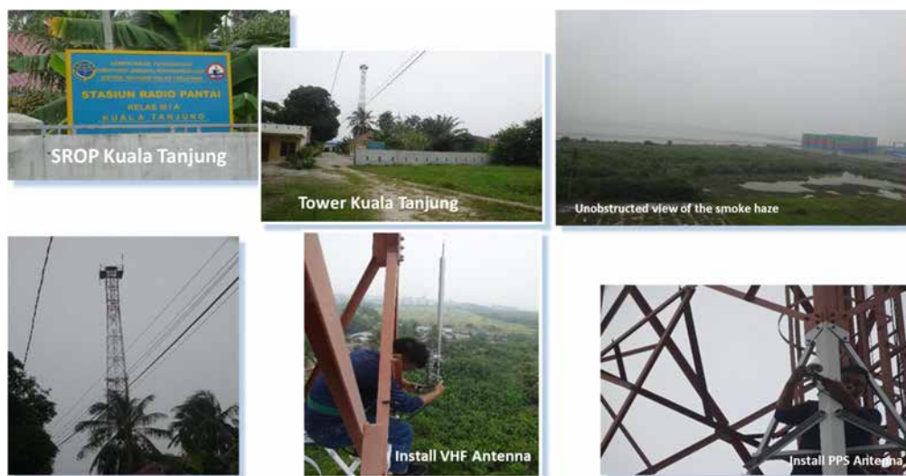
第 5.3 -1 写真 AIS 装置設置状況
