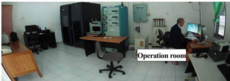
第 4.1.8 -9 写真 運用室
