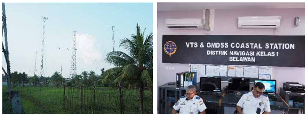
第 4.1.8 -4 写真 VTS と GMDSS の運用室
