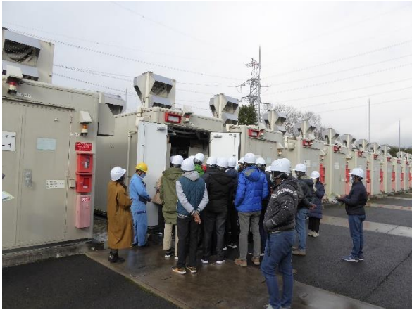
西仙台変電所視察の様子
