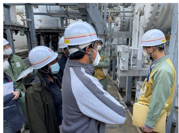
布池変電所視察の様子
