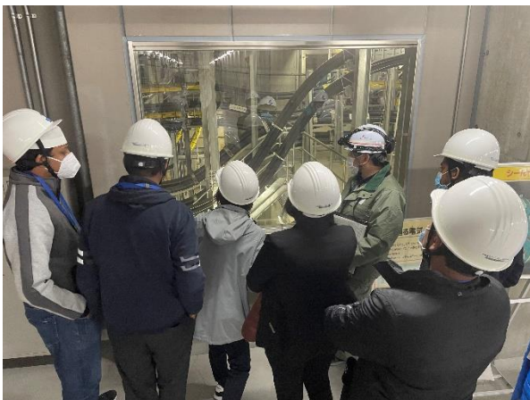
名城変電所視察の様子
