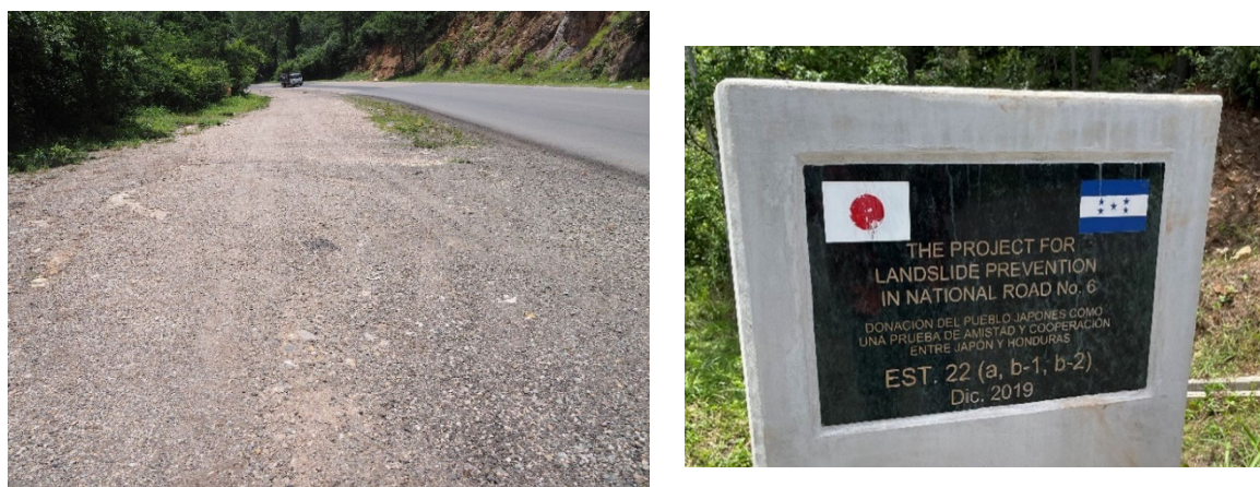
図 5-8 日本の ODA で 2019 年に実施した国道 6 号線沿いの地すべり対策の 2021 年 8 月の状況 (Sta.22km)
