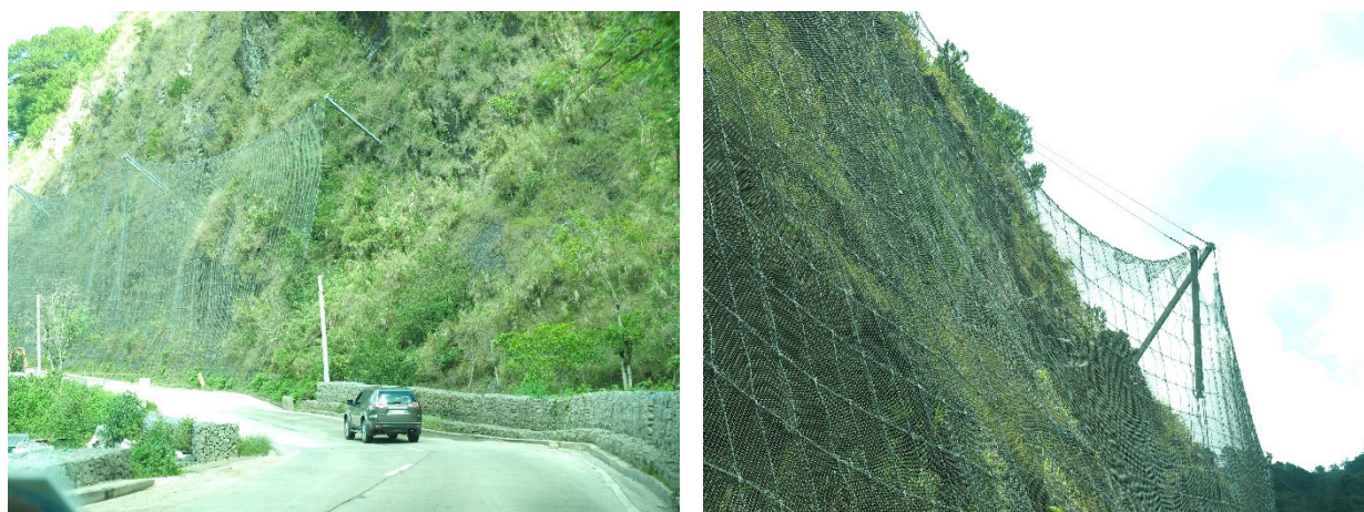
図 5-4 JICA 事業で整備されたポケット式落石防護網工
