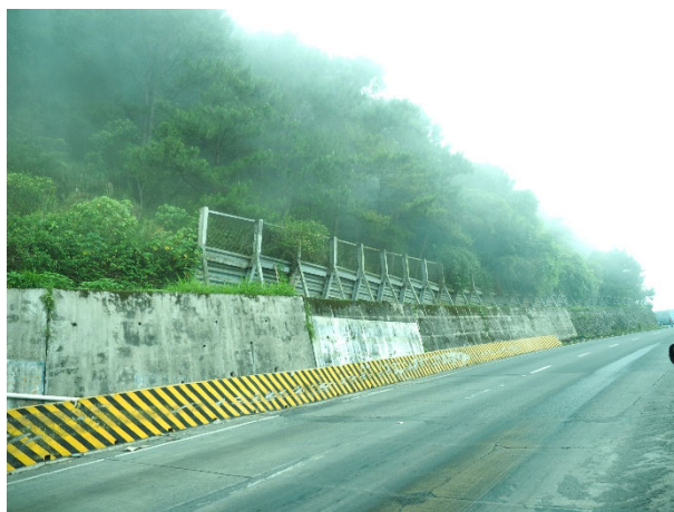
図 5-6 1993 年から 2001 年に実施された日本の Rosario-Pugo-Baguio 道路修復事業で施工された落石防護柵工
