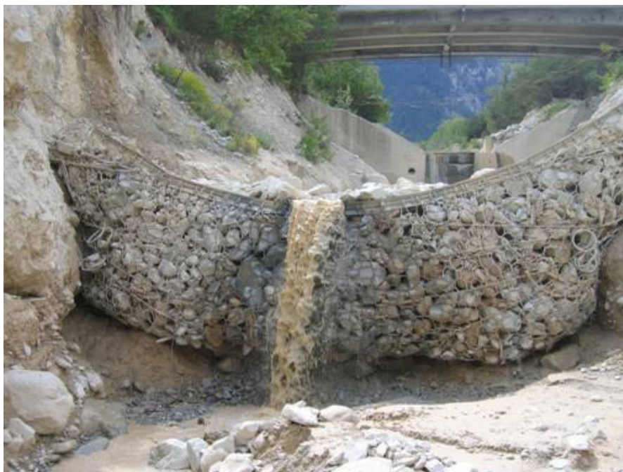
図 8-13 スチールネットによる土石流対策（スイス・イルガーベン：土石捕捉後の状態）
