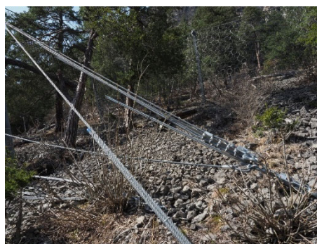
設置されたステンレス鋼棒を使ったブレーキシステム。
