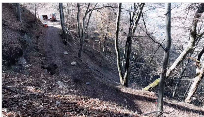
図 8-10 立木を支柱として利用した落石防護柵
