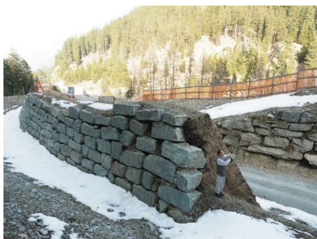
1t の落石が 200km/h で直撃しても耐えられる落石防護土堤（スイス）
