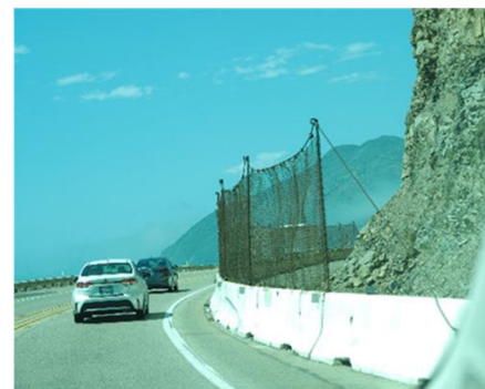
コンクリートブロックによる落石ポケットの確保と簡易な落石防護柵
