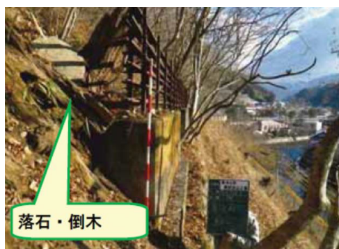
図 3-2 昭和36年（1961年）施工の落石防護柵の例 （林野庁、2018）
