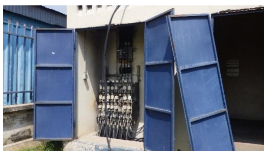
A 変電所内設置キャビン
