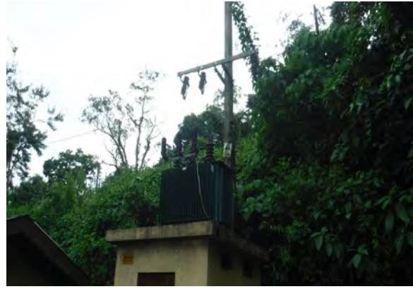
630kVA x 1変圧器 (A&Eビル用)
