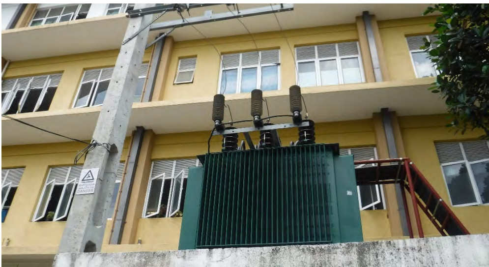
800kVA受電設備
