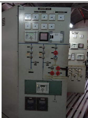
TM1-③ 変電設備建屋内
