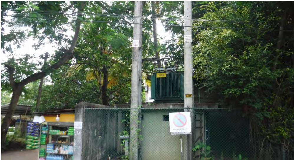
630kVA受電設備
