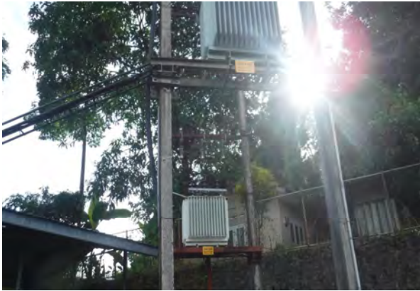
250kVA x 2変圧器 (Blood bank, mainビル用)
