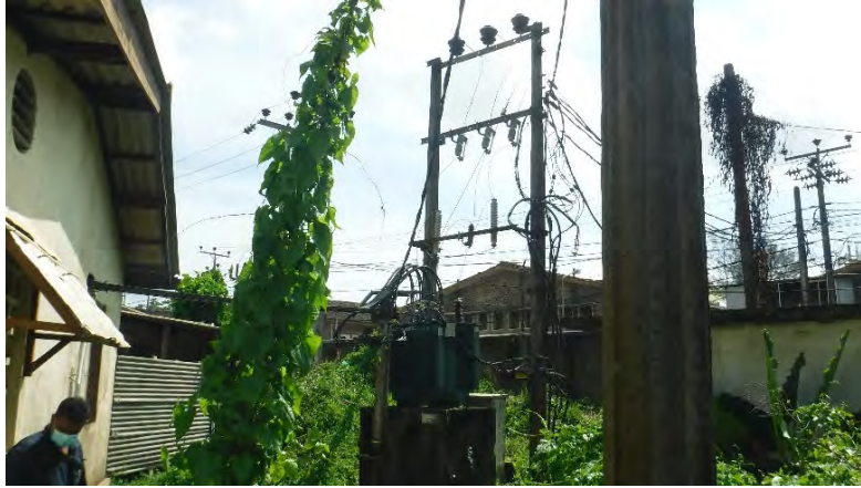
既設変圧器 630kVA
