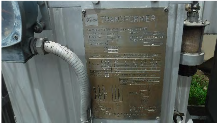
750kVA変圧器(東芝製)
