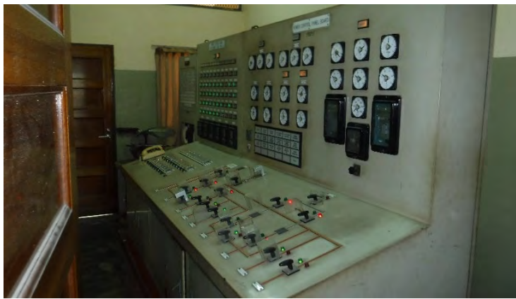
受配電設備監視制御盤
