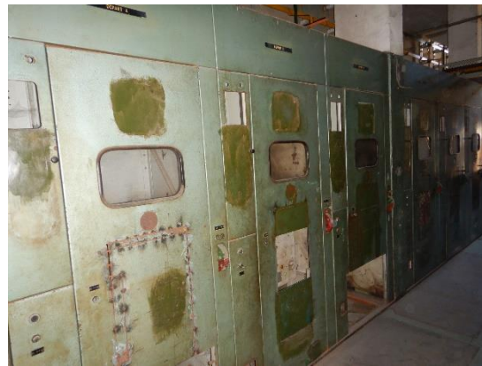
TM1-② 変電設備建屋内
