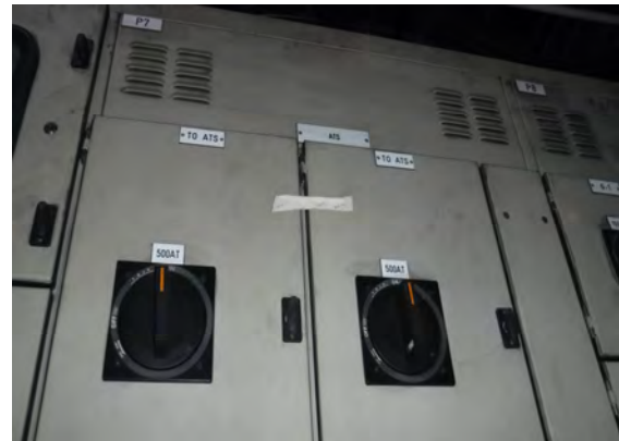
JICAビル用開閉設備 設備改造後太陽光,バッテリー電源 繋ぎこみ予定
