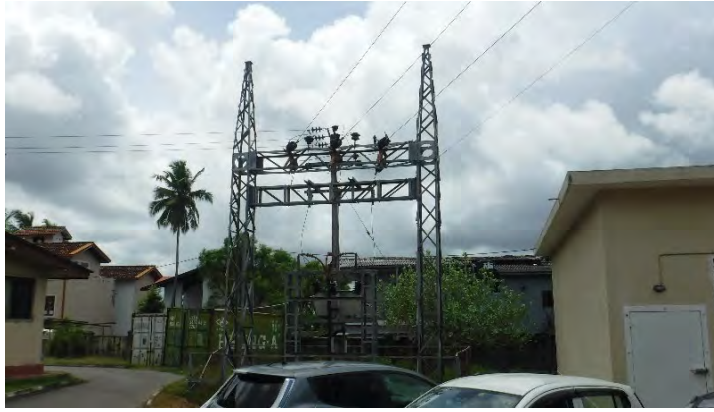
33kV受電設備
