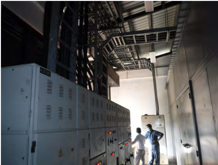
1000kVA 低圧 開閉装置
