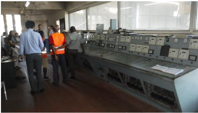
TM2-③ 変電設備制御室内
