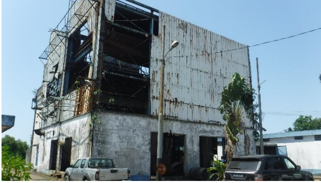
TM2-① 変電設備建屋全景
