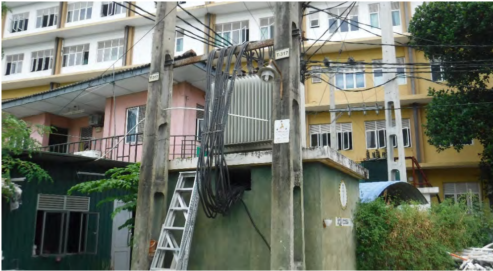
1000kVA 受電設備
