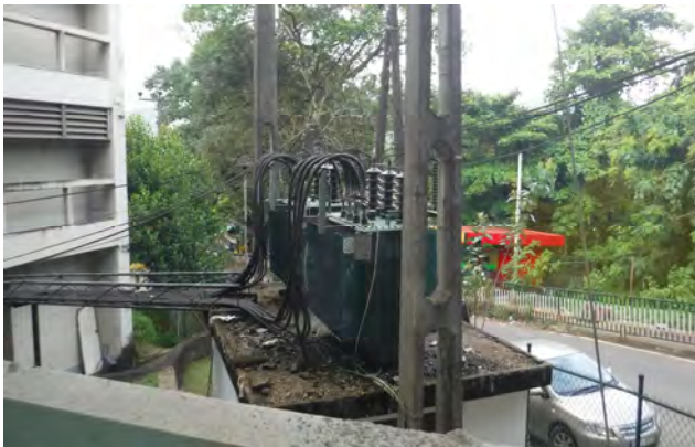
400kVA x 2変圧器 (JICAビル用)
