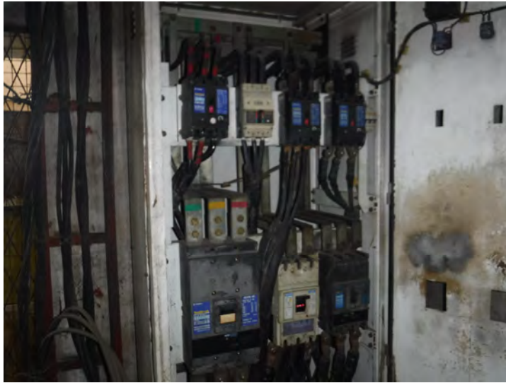
630kVA系統 分電盤(一部焼損)
