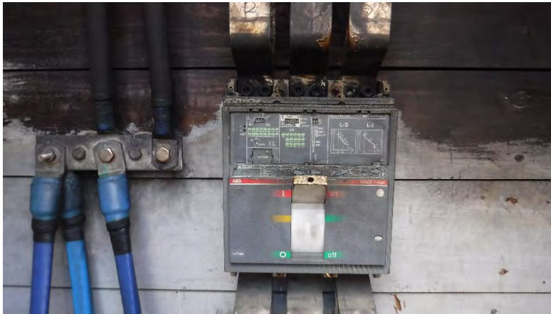
受電変圧器2次CB (小動物侵入により焼損)
