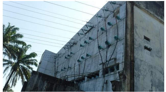
TM2-④ 変電所引き込み線
