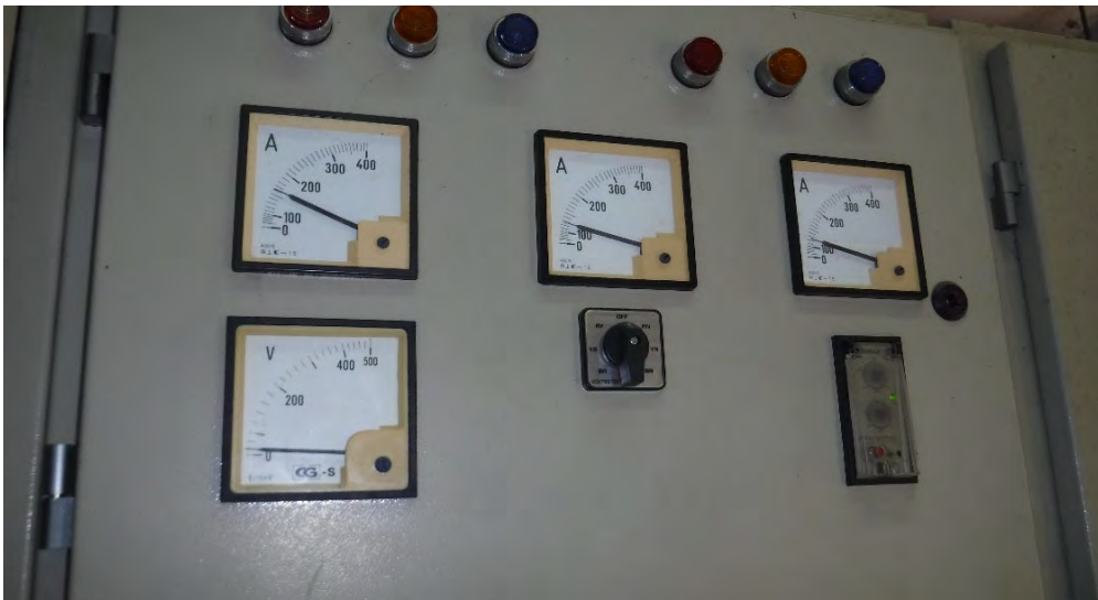
メインフィーダー分電盤
