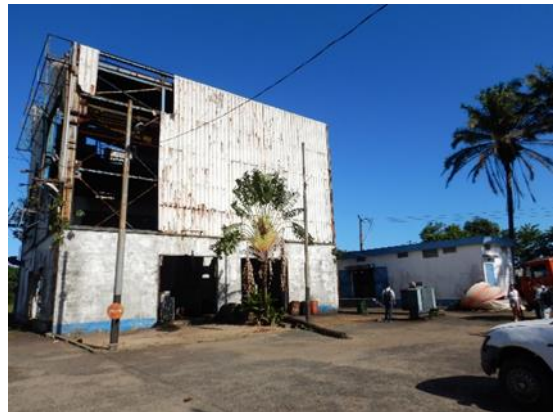
TM-2 変電所 (建屋全体の老朽・劣化及び一部損壊)
