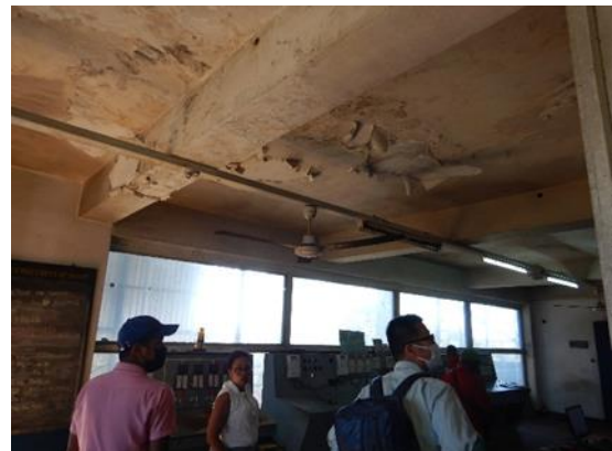
TM-2 変電所 (建屋内天井損壊状況)
