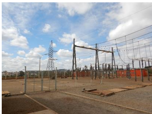
Tana Nord 変電所（変電所ヤード内）
