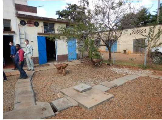
20kV 開閉設備新設予定箇所
