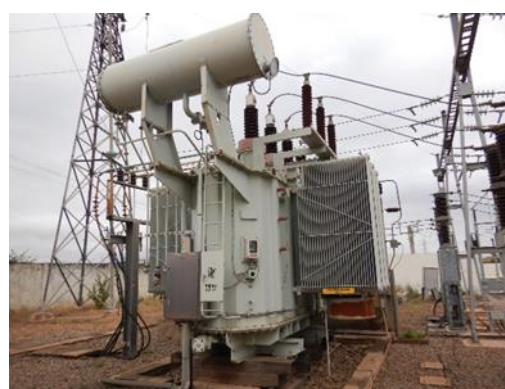
Tana Sud 変電所（既設変圧器）
