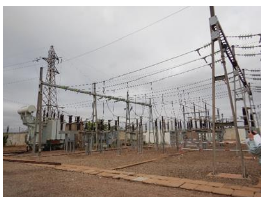
Tana Sud 変電所（変電所ヤード内）
