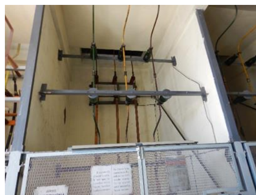
Mandrozeza 変電所（5kV 開閉設備）
