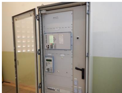
Tana Nord 変電所（ベイコントロールユニット）
