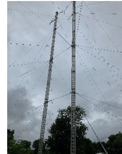
写真1: 仮設送電塔 (132kV)
