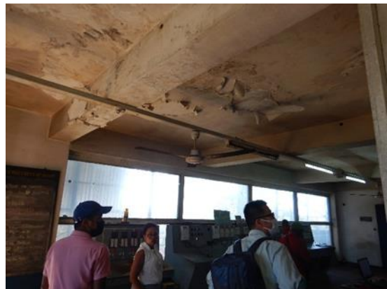
TM-2 変電所 (建屋内天井損壊状況)
