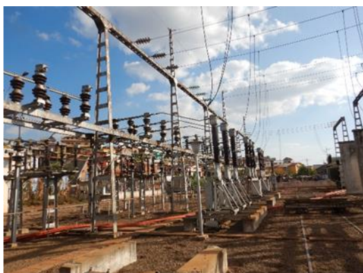
Ambodivona 変電所（変電所ヤード内）
