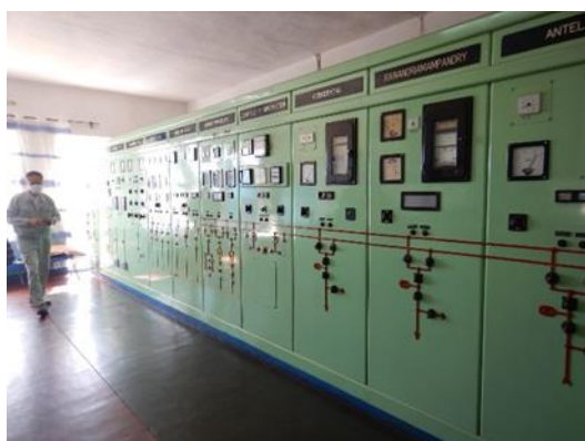
Mandrozeza 変電所（中央制御室）
