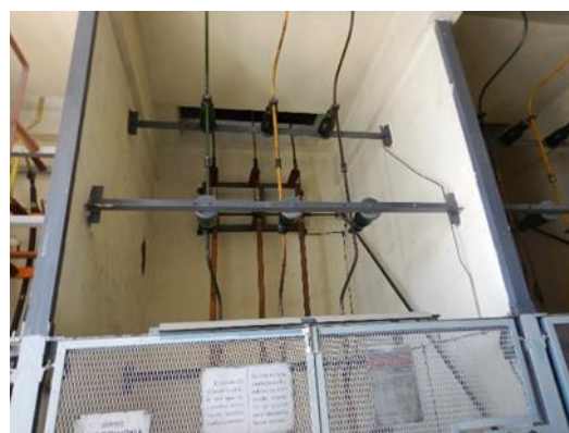
Mandrozeza 変電所（5kV 開閉設備）
