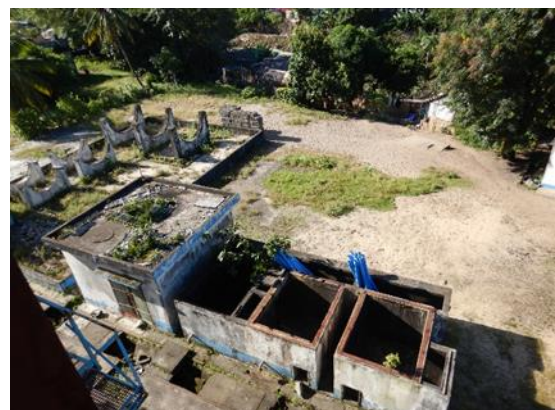
TM-2 変電所 (建屋隣に旧発電所設備跡有)
