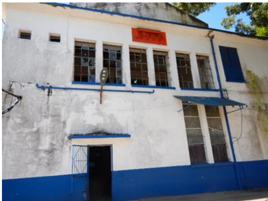
TM-1 変電所建屋 (市民からの投石で窓ガラスは破損)
