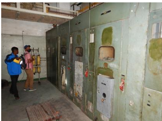
TM-1 変電所 (一部機器は使用不可 (劣化・焼損等))
