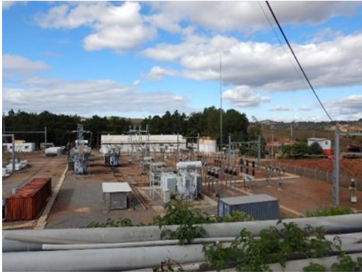
PIA 変電所変電所(新設用変圧器保管中)
