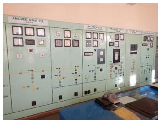
Ambodivona 変電所（中央制御室）
