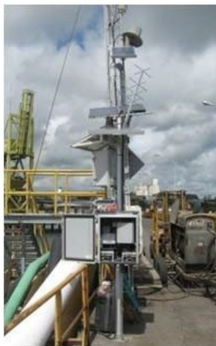
Figura 24. Estación mareográfica en puerto de Acajutla
