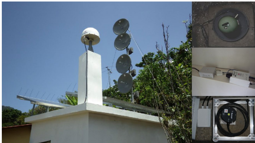
Figura 21. Equipos sísmicos y de GPS del MARN instalados en campo
