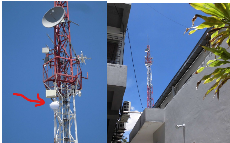
図 3-4-1 MARN 本部に設置した無線通信機とアンテナ（赤矢印がアンテナ。その裏側に無線通信機がある）ゴビエルモ中継通信所に設置したものと交信。
