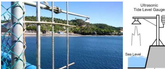
Figura 22. Estación mareográfica ubicada en el puerto de La Libertad. La estación cuenta con un sensor de ultrasonido
