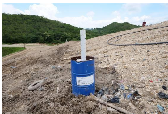
写真 7-39 設置されているガス抜き管
