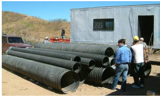
写真 7-16 使用された浸出水集水管
