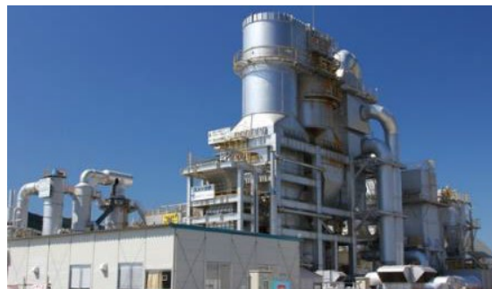
写真 5-12 仮設焼却炉 (小泉地区：2013年5月)
