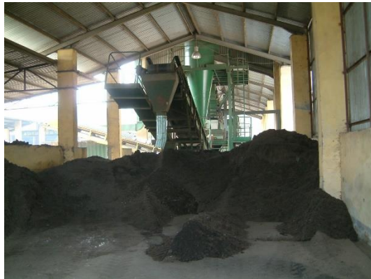
写真 7-74 コンポスト化施設
