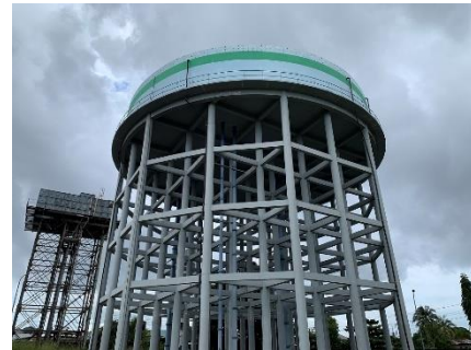
写真 2-10 ZUWSP で整備した高架式配水池
