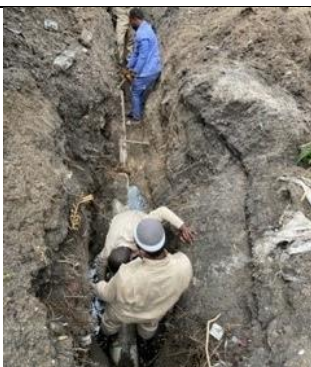
巻頭写真5 石綿管φ200の漏水修理状況 (継手から漏水。管を外して両側の継手をずらし、漏水 している方の継手材を取り替えている。)
