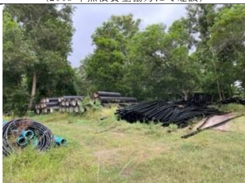
巻頭写真3 ウエレゾ配水池での資材の保管 (直射日光にさらされ、紫外線の影響が懸念される)
