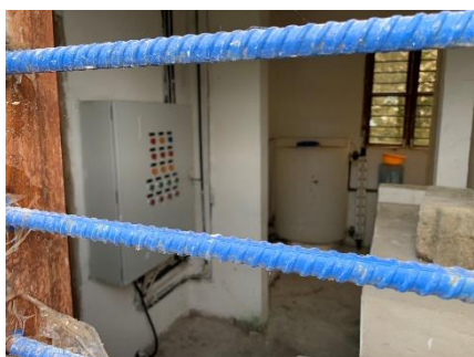
写真 2-7 ZUWSP で整備した消毒設備(1)
