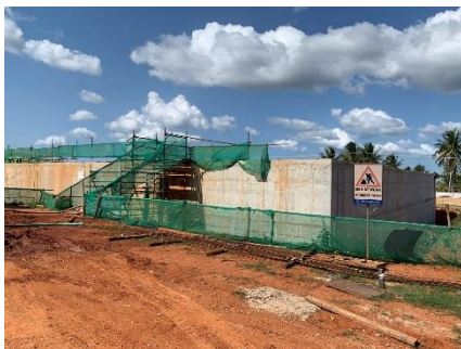
写真 2-3 半地下配水池
