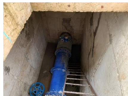
写真 2-14 ZUWSP で整備した配水流量計
