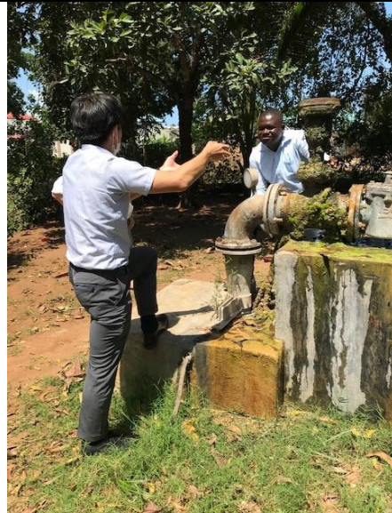
巻頭写真 12 取水井戸の空気弁からの漏水 (点検した形跡がないため、調査団員が空気弁の維持管理について指導)
