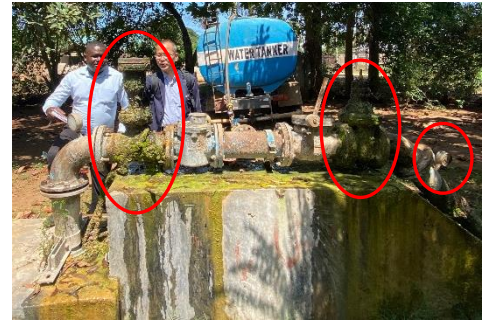
写真 2-16 井戸水源での漏水
