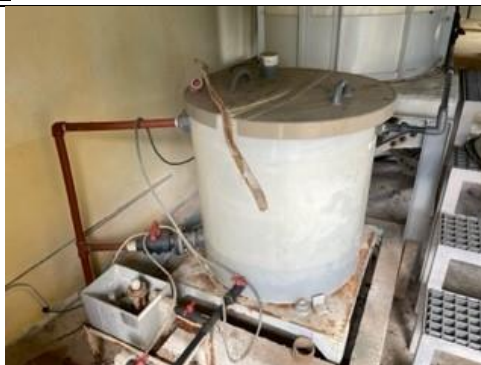
巻頭写真2 ウエレゾ配水池 消毒設備 (攪拌設備は腐食により故障している)
