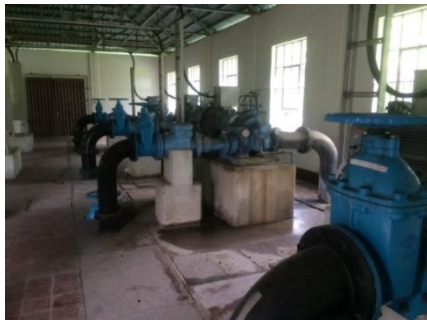
写真 2-11 無償資金協力で整備した揚水ポンプ
