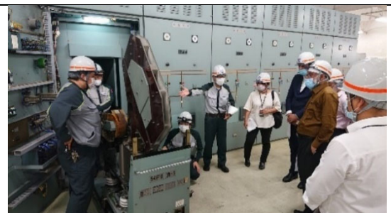
写真 34:遮断器の保守作業の視察
