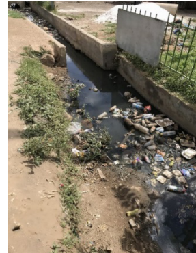
ゴミで詰まった側溝
