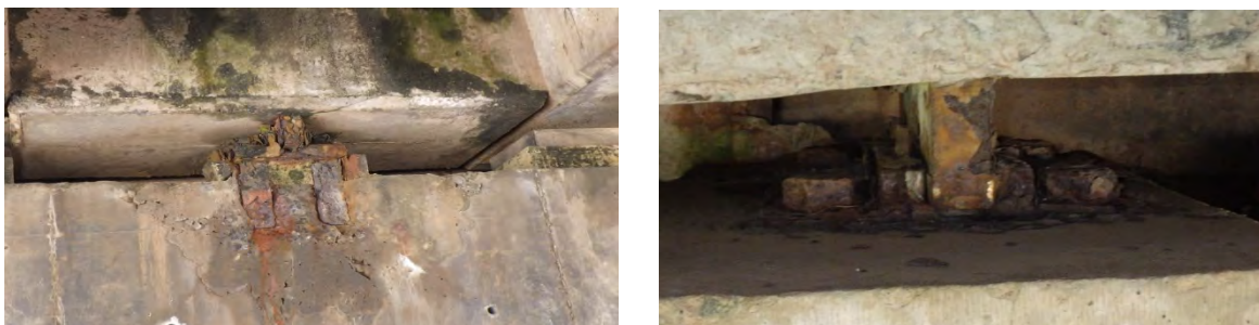
図1 落橋防止装置の腐食状況（ガーナ、研修員撮影）
