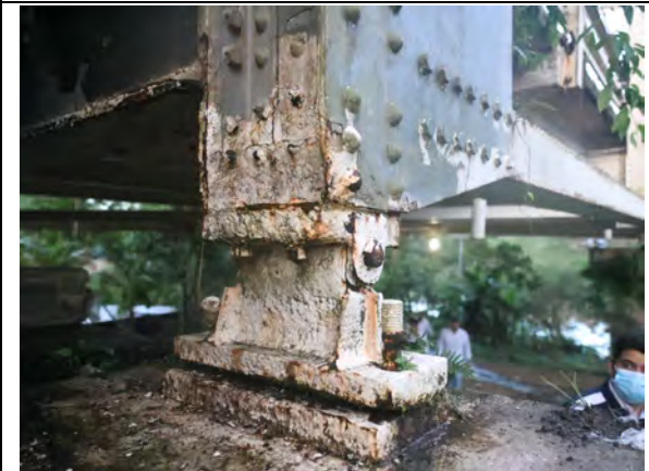
エスペランザ橋支承劣化状況
