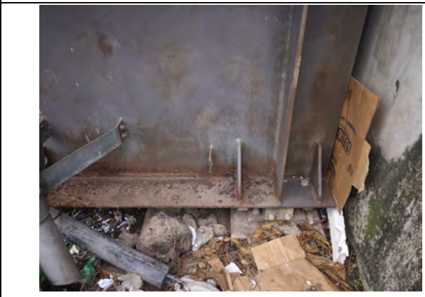
テコロステーテ橋の腐食状況
