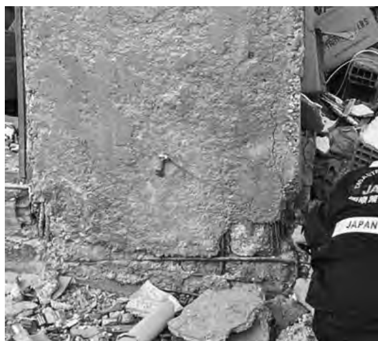
(a) 壁脚部の圧壊
