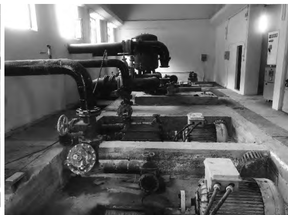
ポンプは老朽化が進んでいる
