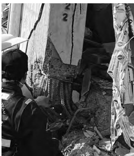
(a) 壁脚部の圧壊
