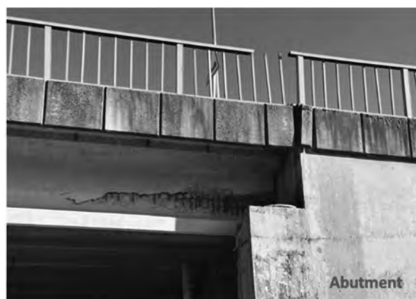
図3-50 せん断キー及び桁端の損傷（アンタキヤ市国道 D817 号 高架橋）
