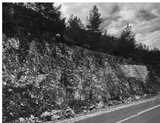
(a) 切土法面からの落石が点在
