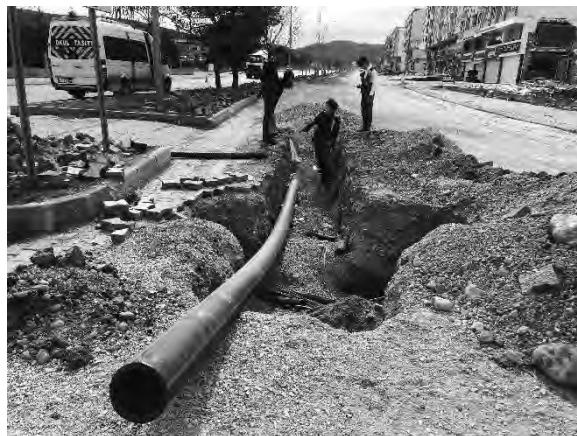
配水池までの HDPE 送水管
