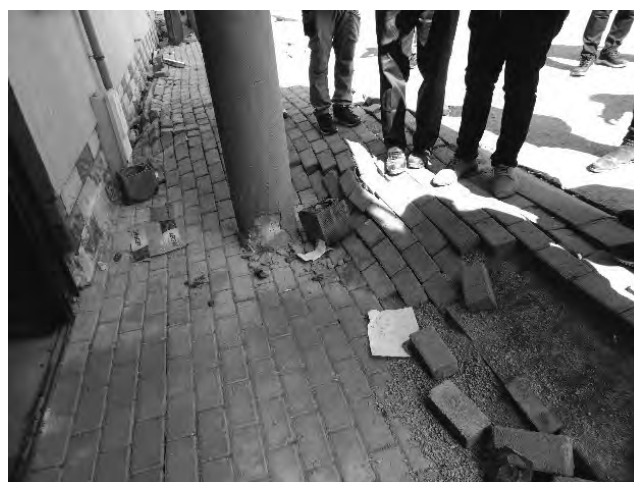
(a) 正面玄関前の沈下
