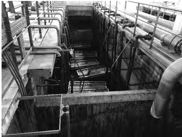
メンブレン装置破損
