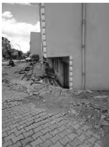
(a) 建物北側の沈下
