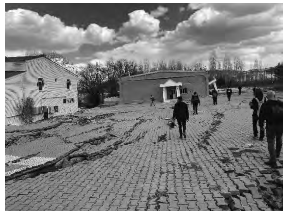
(b) 地すべりによる地盤の変状（アドウヤマン）
