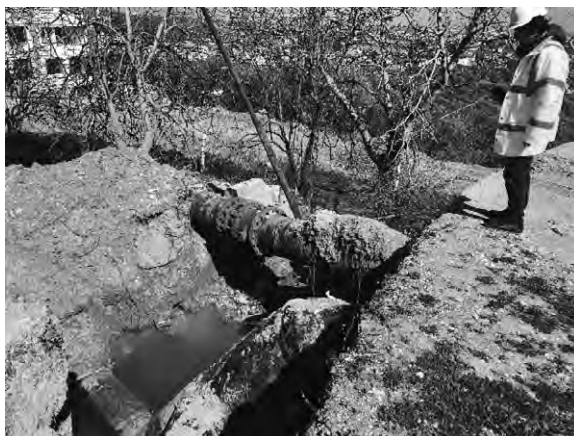
送水管の亀裂
