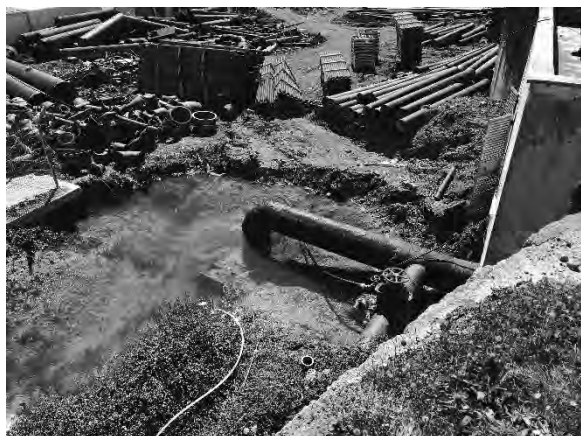
送水管から水が漏れている
