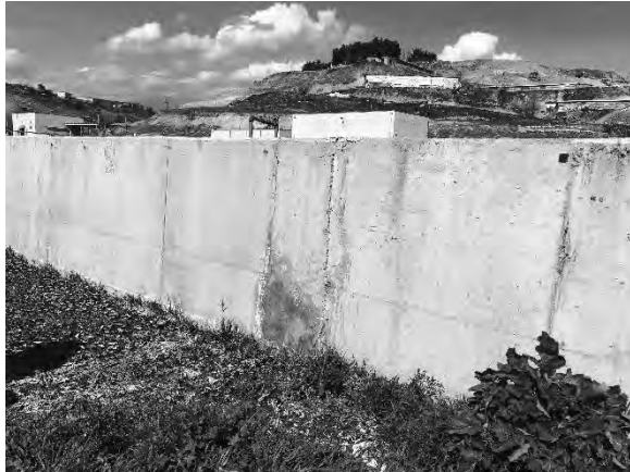
沈殿池側面のひび
