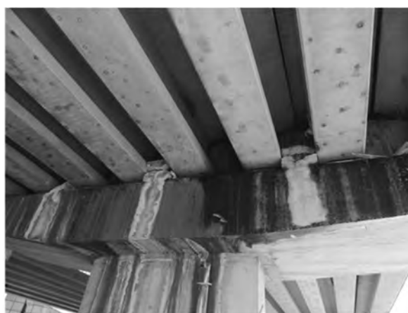
図3-51 せん断キー及び桁端の損傷（アンタキヤ市国道 D817 号 高架橋）
