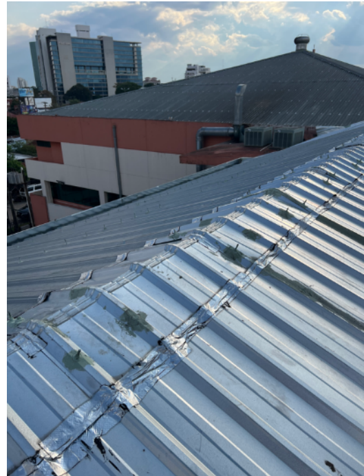
サンタクルス中央日本人会館の 雨漏りのため改修が待たれる金属屋根
