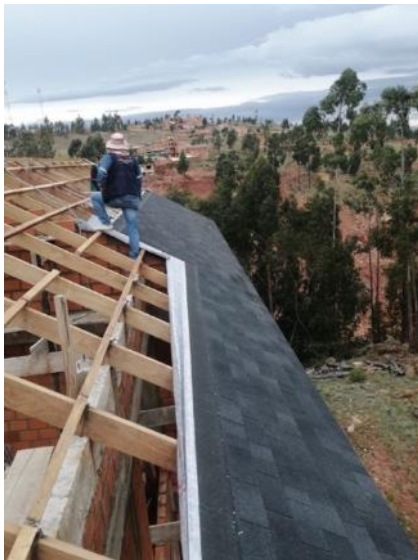
足場はなく、母屋・垂木の間隔も広い(日本の倍)のため墜落の危険性が高い
