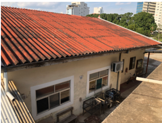
ボリビア日系人協会連合会の講堂 老朽化が進み改修が必要な屋根
