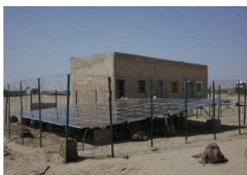
図 6-61 ソーラーパネルと防護柵の設備
