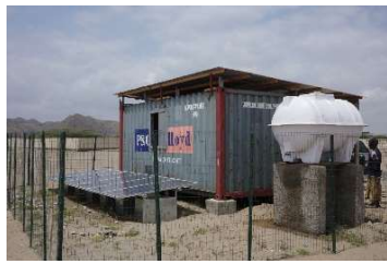
図 6-63 フェンス内に設置されたソーラーシステム
