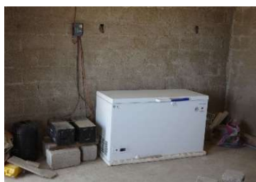
図 6-60 ブラ CFC に設置されたソーラー式冷凍庫
