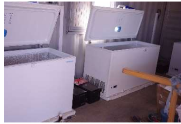
図 6-64 ヒルギゴ CFC に設置された 3 台の冷凍庫
