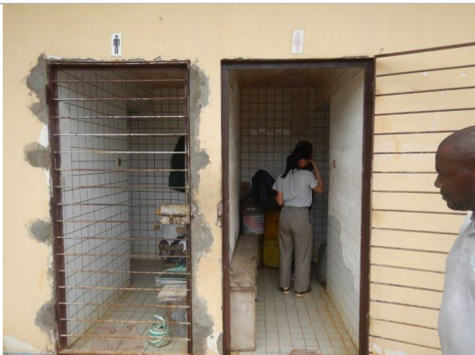
15 : Le nombre de toilettes insuffisant.
