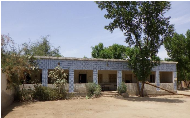
Kh05 GGES Bajeed Fakir:既存校舎外観。校舎裏側の外壁にはクラックが見られ、モルタルは剥離している。
