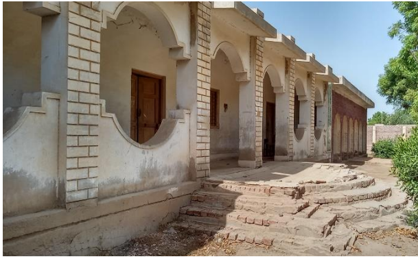
Na03 GGES Jalalani:既存校舎外観。入口階段は崩れ落ち、廊下の床は一部陥没している。
