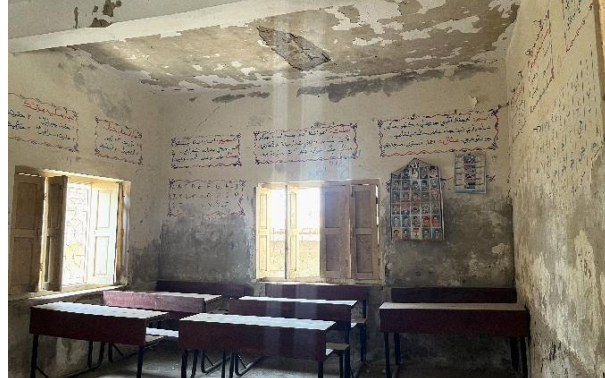
同左: 既存校舎教室内部。天井の塗装、モルタルは剥離し、鉄筋が露出している部分が散見される。
