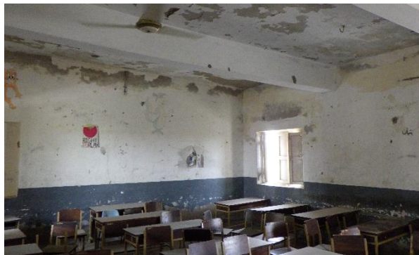
同左:既存校舎教室内部。廊下の床は陥没し、骨材が露出している。天井は、鉄筋が露出している部分が散見される。
