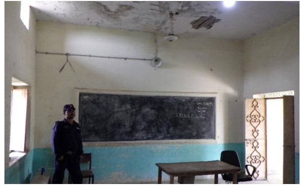
同左:既存校舎教室内部。天井の一部で鉄筋が露出している。木製の窓枠は一部破損している。
