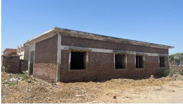
Ba06 GGES Ibrahim Chandio: 既存校舎外観。窓庇はRCが爆裂し、鉄筋が露出している。建物を囲う塀は一部残存しているが、劣化が激しい。
