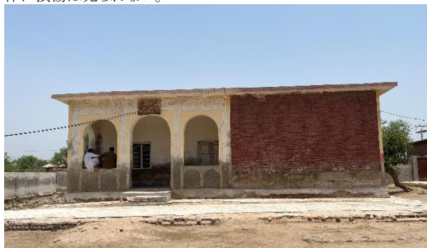
Mi04 GGES Kachelo Farm:既存校舎外観。窓底にはクラックが見られ、一部鉄筋が露出している。外巾木は洪水により、浸食されている。
