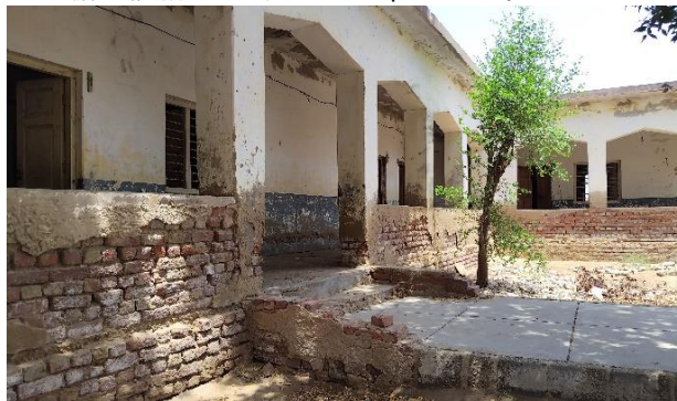
Mi03 GGES Deh 294:既存校舎外観。階段のモルタルは剥がれ、レンガが崩れ落ちている。外周の底にクラックが見られる。
