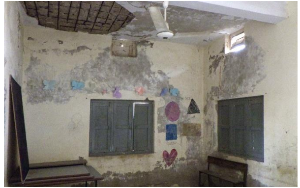
同左: 既存校舎教室内部。天井は、鉄筋が露出し、危険な状態である。
