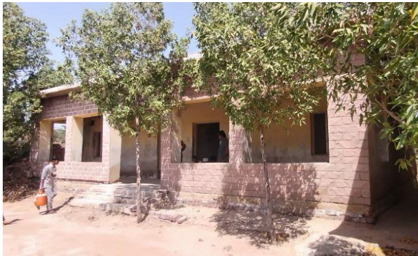
Ba01 GGES Gullan Khaskheli: 既存校舎外観。庇の RC は爆裂し、鉄筋が露出した部分が散見される。
