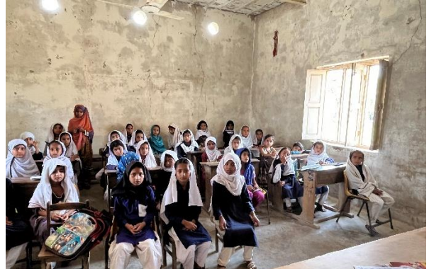
同左: 既存校舎教室内部。内壁にクラックが見られ、雨漏れも広範囲に広がっている。
