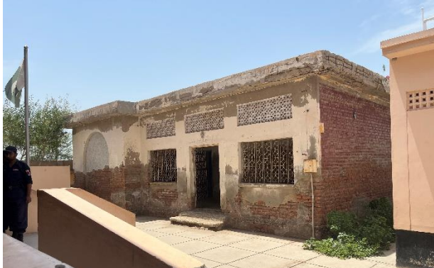
Su04 GGES Moto Mirbahar: 既存校舎外観。バラベットの RC は爆裂し、鉄筋が露出している。
