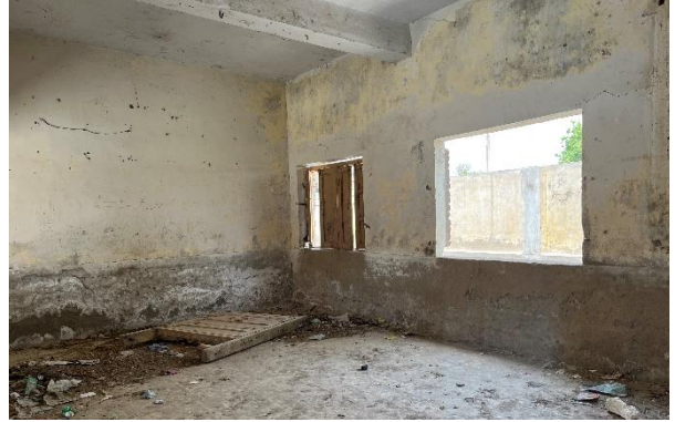
同左: 既存校舎教室内部。窓の臥梁や木製の扉は破損している。
