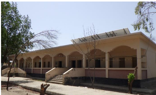
Na01 GGES Quest: 協力された中等学校校舎外観。外壁塗装の一部が剥がれおちている。
