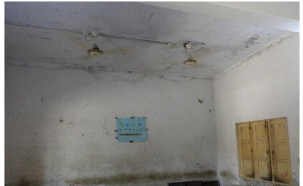
同左: 既存校舎教室内部。天井の一部で鉄筋が露出し、雨漏りのしみがある。
