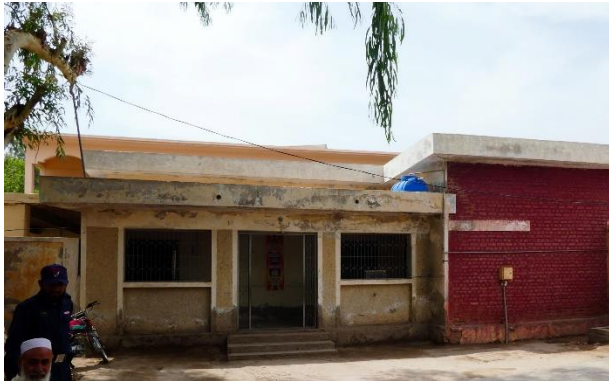
Gh01 GGES Officer Colony Ghotki: 既存校舎外観。外壁のレンガは崩れ落ち、庇にはクラックが散見される。
