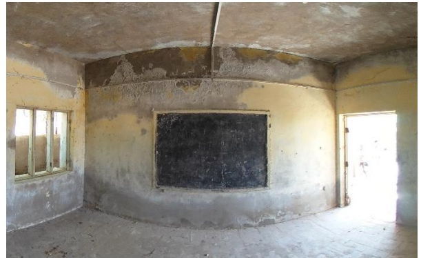
同左:既存校舎教室内部。壁は雨漏りにより塗装、モルタルが剥離し、天井にはクラックが散見される。
