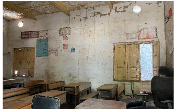
同左:既存校舎教室内部。内壁にはシロアリによる被害が見られる。木製の窓は一部破損している。
