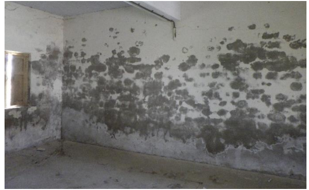
同左:既存校舎教室内部。床の損傷が激しく、教室の床スラブには大きなクラックが見られる。陥没している部分もある。
