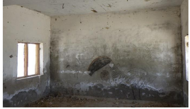
同左: 既存校舎教室内部。壁は水害により塗装・モルタルが剥離している。床スラブには表面の隆起と陥没が見られる。
