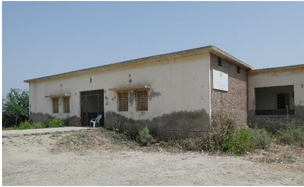
Mi08 GGES Muhammad Hassan Mari:既存校舎外観。外壁のモルタルは剥離し、レンガが露出している。
