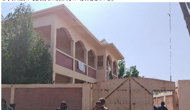
Ba01 GGES Gullan Khaskheli: 協力された中等学校校舎外観。ゲートが錆びている。
