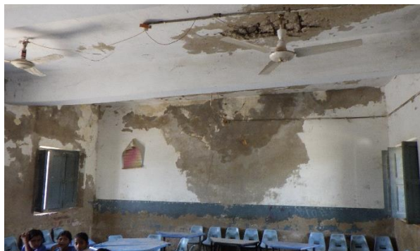
同左:既存校舎教室内部。天井は、鉄筋が露出した危険な状態であるが、利用されている。
