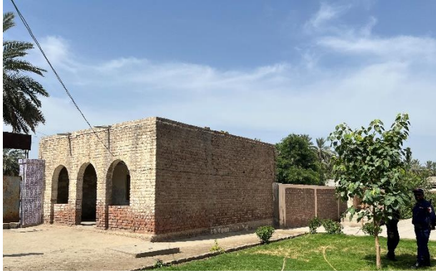
Kh09 GGES Jani Buriro: 既存校舎外観。建物全体に劣化が進んでいる。
