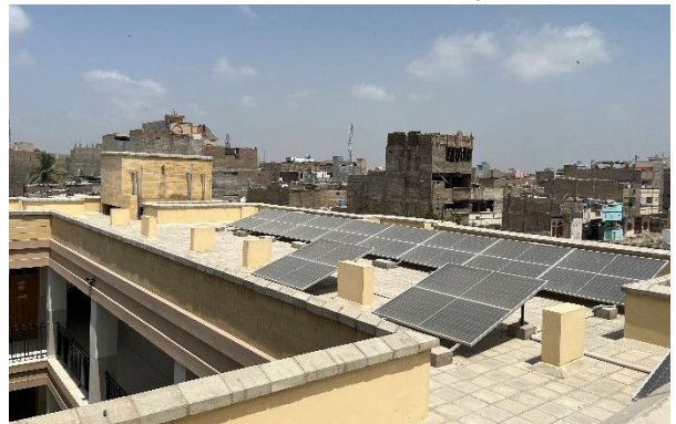
同左: 屋上に設置された計 48 枚の太陽光パネル。太陽光発電と公共の電力を併用している。
