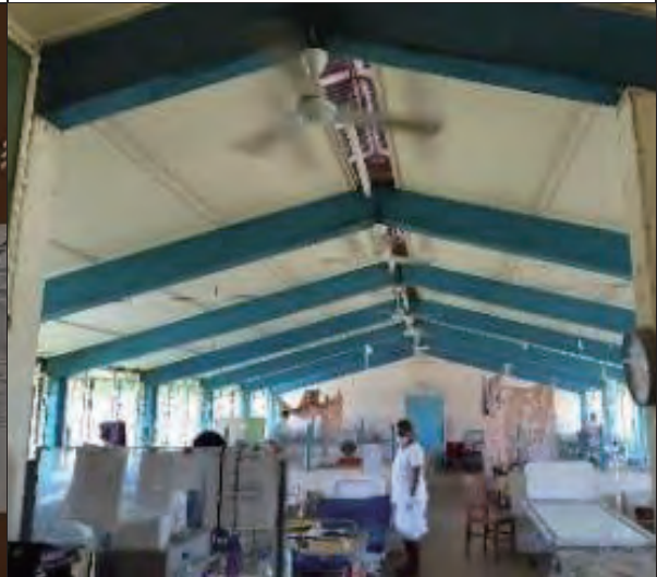
既存病棟：自然換気が十分に行われていない。
