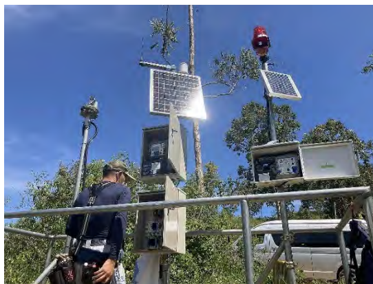
2022年1月25日 Baddula 県 Weeriyapura に設置された地すべり遠隔監視システム
