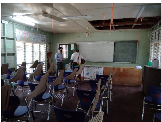
教室棟内観（天井破損）
