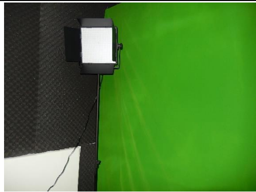
スタジオに設置されている照明
