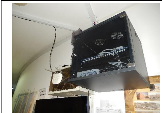
教室外に設置されたサーバーと Wifi ルーター
