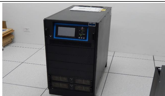
スタジオ横に設置されている UPS
