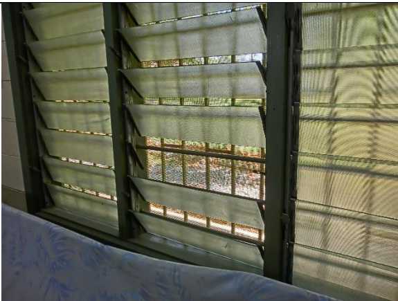
ルーバー窓が設置されており修復が必要である
