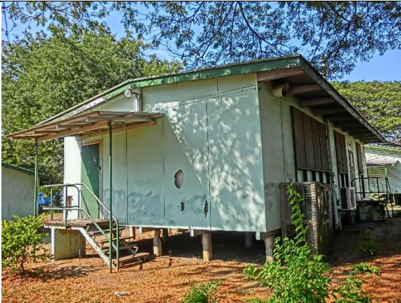
理科教室（近年使用されておらず要改修）
