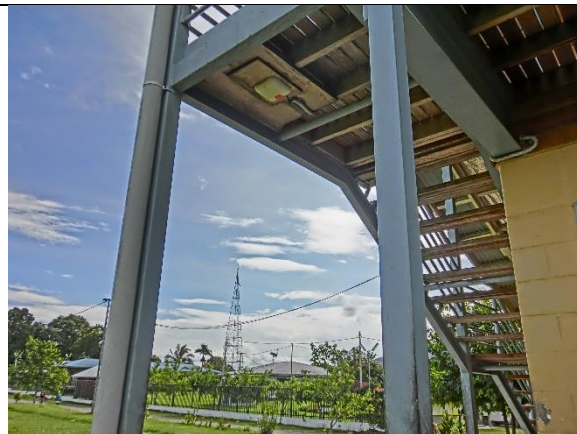
Wifi 機材が設置されている理科実験室棟
