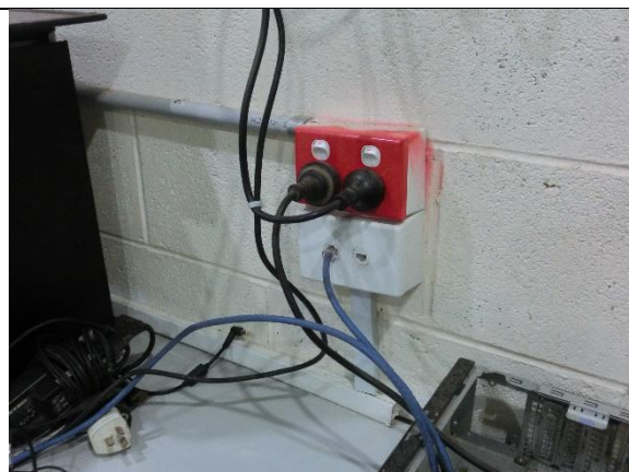
UPS 給電タップ（赤色）
