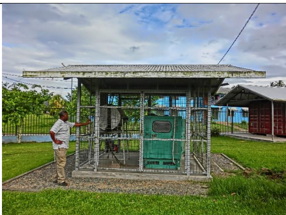
自家発電設備
