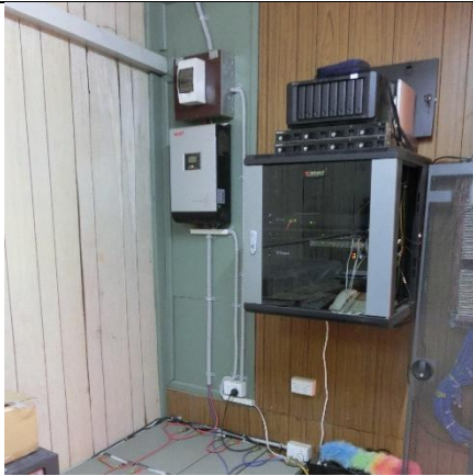
サーバールーム（写真下方は UPS）
