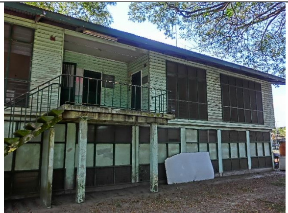
数学教室棟外観。木造で一部劣化あり。
