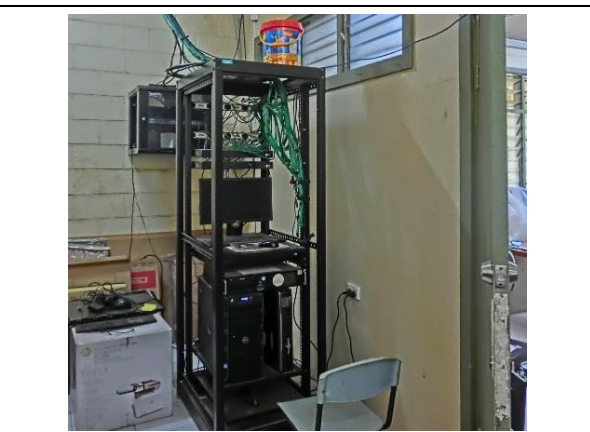
ブレードサーバーユニット (UPS 配置有り)
