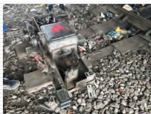
破壊された電気転てつ器
