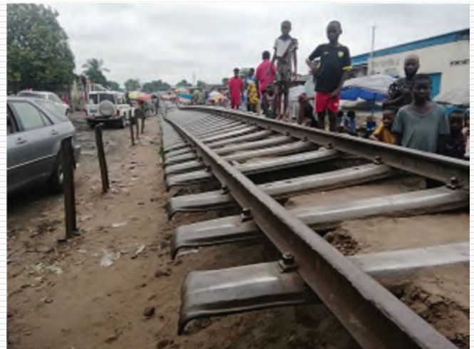
崩壊した路盤
