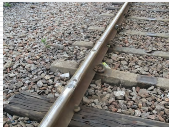
レール頂面の損傷
