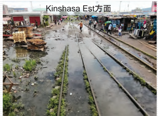
Kinshasa Est方面 駅構内で水没した分岐器
