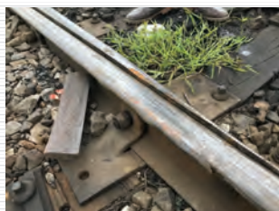
レール摩耗箇所
