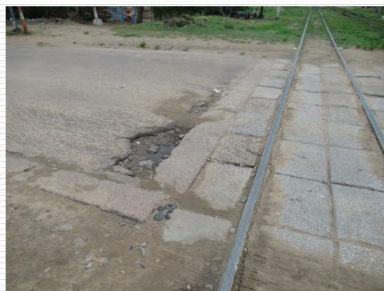
踏切板の損傷
