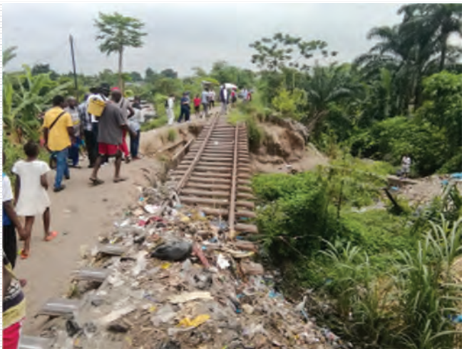
大きく崩壊した盛土
