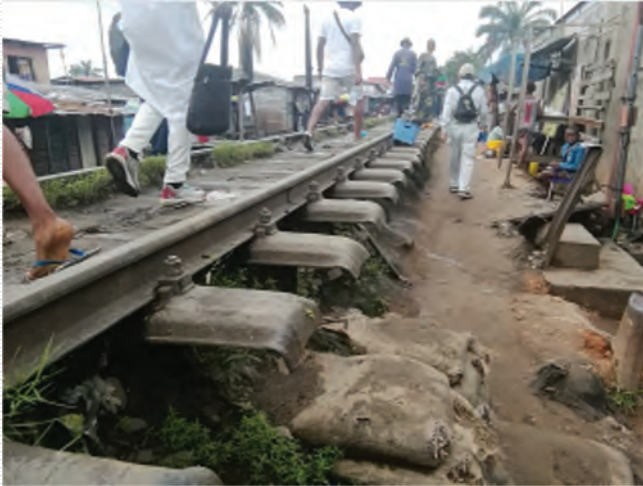
削り取られた路盤と近接した住居
