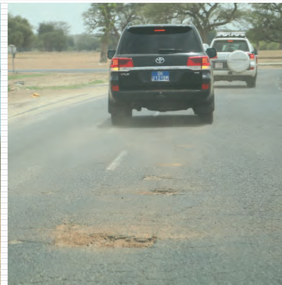
劣化した道路の舗装
