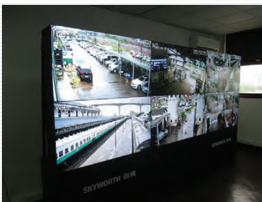
監視カメラのモニター
