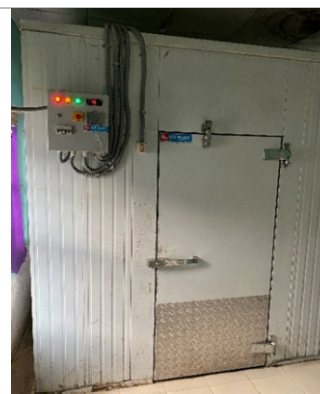
発酵用冷蔵倉庫
