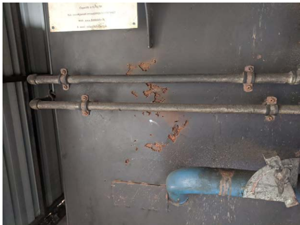
トリンコムリー病院の既存焼却炉の腐食の様子
