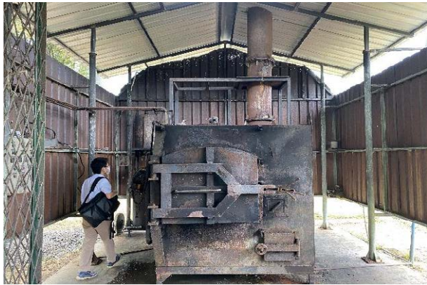
アビッサウェッラ病院の既存焼却炉の様子
