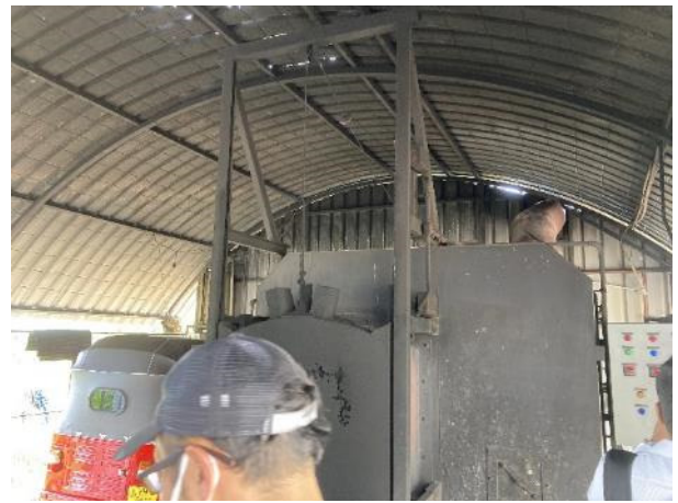
ハンバントタ病院の既存焼却炉の様子
