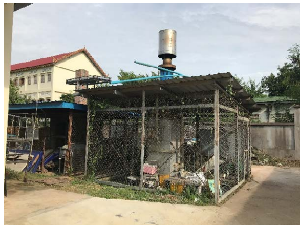
ポイペト病院の既存焼却炉 (旧機械式)の様子
