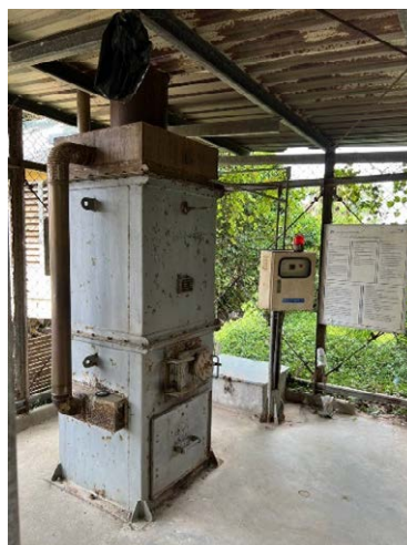
ペアレン病院の既存焼却炉 (旧機械式)の様子
