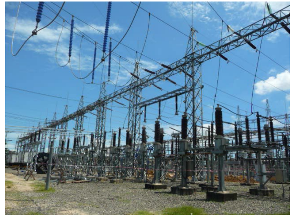
ウブンゴ変電所開閉設備
