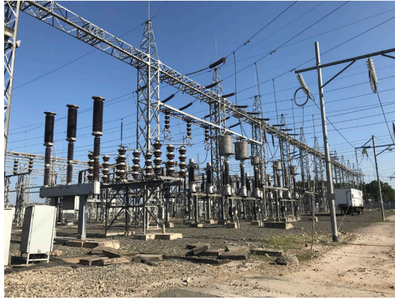
ウブンゴ変電所
