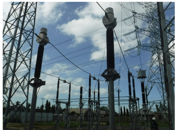
キネレジIガス火力発電所併設開閉所（2）
