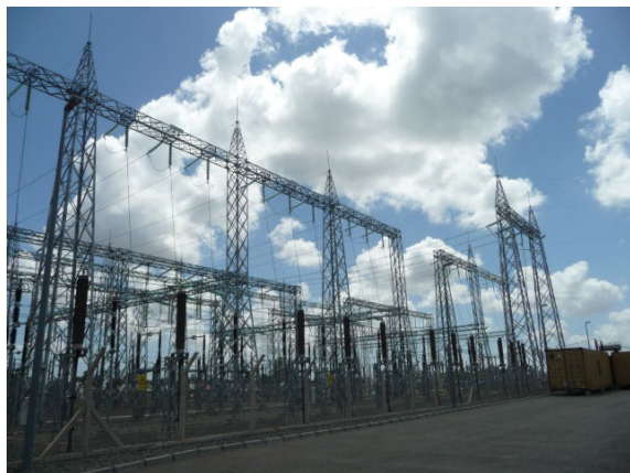
キネレジIガス火力発電所併設開閉所（1）
