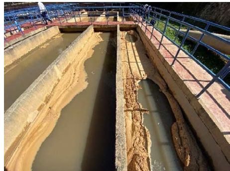
薬品混和地・フロック形成池 (Kajulu 浄水場)
