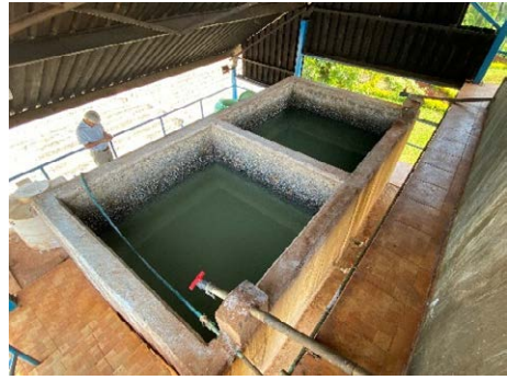
薬品混和池 (Kiawambeu 浄水場)
