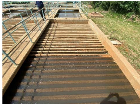
フロック形成池 (Juja 浄水場)
