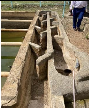
薬品混和池・フロック形成池 (Malewa 浄水場)
