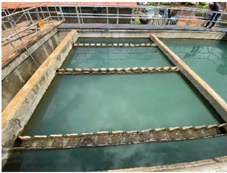
沈殿池 (Milimani 浄水場)
