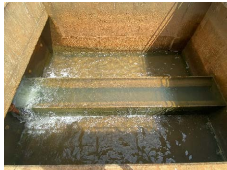
急速ろ過池 (Jacaranda 浄水場)
