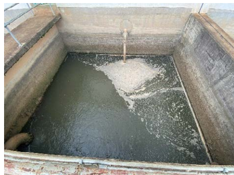
急速ろ過池 (Kapolet 浄水場)
