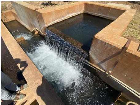
薬品混和池 (Mwangaza 浄水場)
