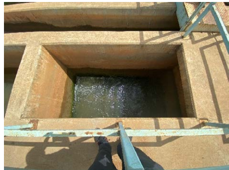
急速ろ過池 (Juja 浄水場)
