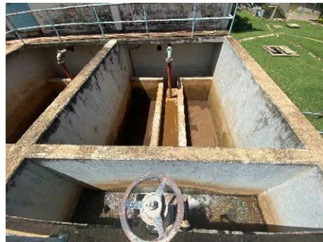
急速ろ過池 (Bungoma 浄水場)
