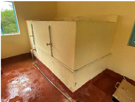
塩素注入池 (Kathuniri 浄水場)
