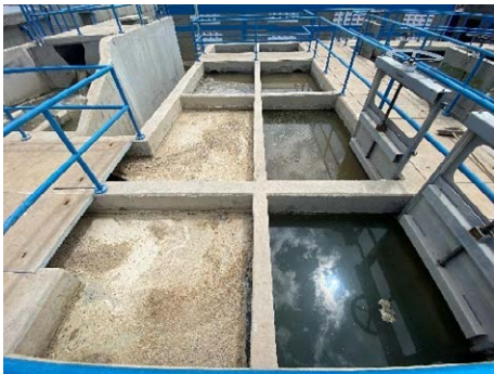
薬品混和池・フロック形成池 (新 Mavoko 浄水場)
