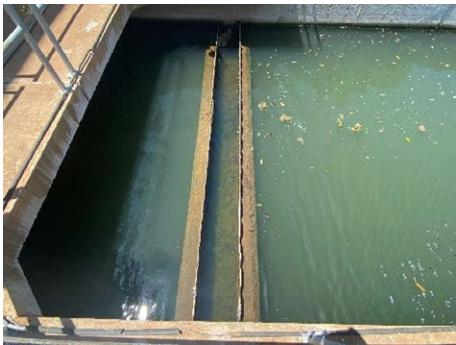
沈殿池 (Isiolo 浄水場)
