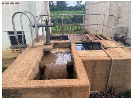
薬品混和池・フロック形成池 (Kapolet 浄水場)
