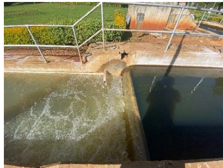
薬品混和池・フロック形成池 (Chebara 浄水場)
