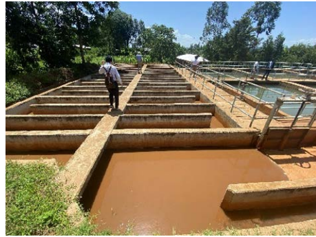
薬品混和池・フロック形成池 (Bungoma 浄水場)
