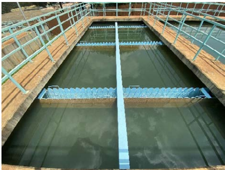
沈殿池 (Jacaranda 浄水場)
