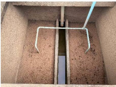
急速ろ過池 (Malewa 浄水場)
