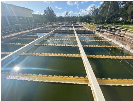
沈殿池 (Chebara 浄水場)
