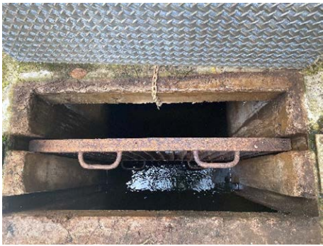
Thambana 取水口 (スクリーン)
