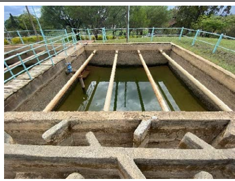
沈殿池 (Malewa 浄水場)
