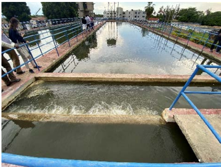
沈殿池 (Dunga 浄水場)
