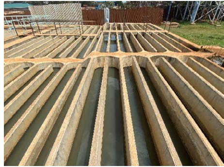
フロック形成池 (Jacaranda 浄水場)
