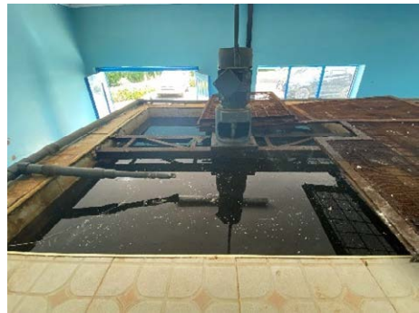
薬品注入設備 (Kanyoni 浄水場)
