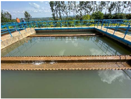
沈殿池 (Kiawambeu 浄水場)
