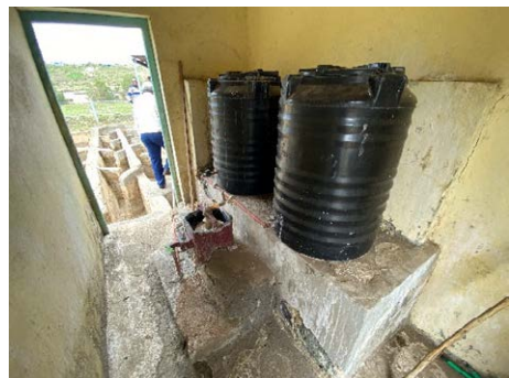
薬品注入設備 (Malewa 浄水場)
