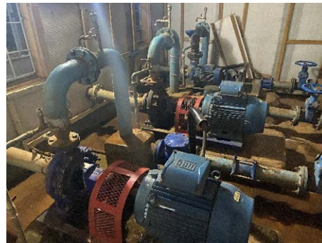
薬品注入ポンプ (Kigure 浄水場)
