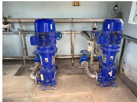
逆洗ポンプ (新 Mavoko 浄水場)
