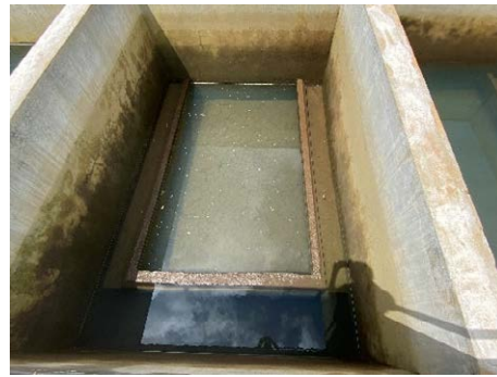
急速ろ過池 (Milimani 浄水場)
