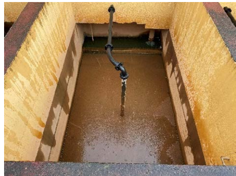
急速ろ過池 (Mereroni 浄水場)
