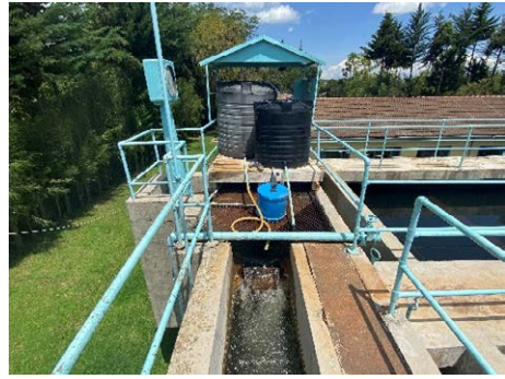
薬品混和池 (Kanyoni 浄水場)
