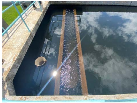
沈殿池 (Kanyoni 浄水場)
