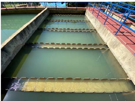
急速ろ過池 (Kajulu 浄水場)
