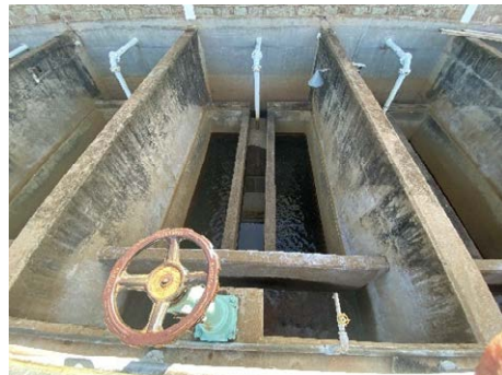
急速ろ過池 (Chebara 浄水場)
