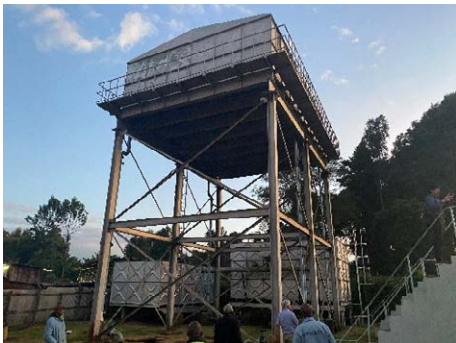
逆洗タンク (Kigure 浄水場)
