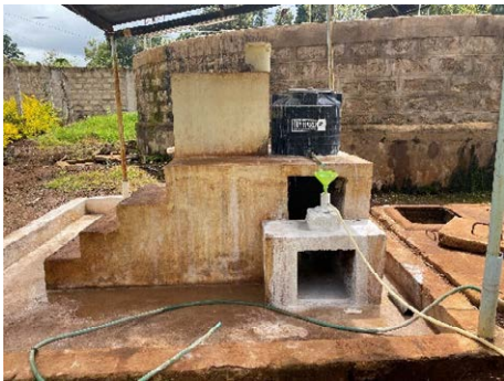
薬品注入設備 (Milimani 浄水場)
