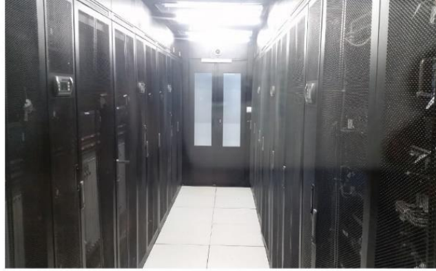
Fig D. Data Center
