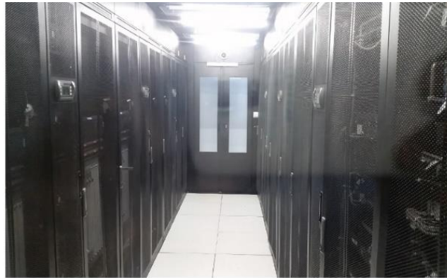
Fig D. Data Center
