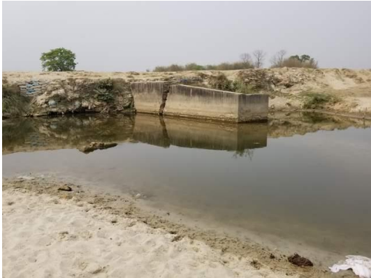
横断排水工 (CDW-07) : アウトレット側から望む。横断工全体の崩落を確認。幹線水路盛土も、土嚢により補強が施されているが、強度が十分とは言い難いと思料される。
