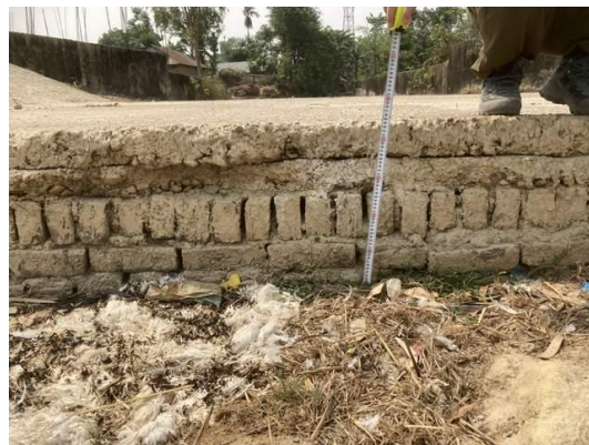
用水路サイホン(CUP2): 左写真と同じ構造物の、河川横断部天端の接写である。レンガが露出しており、サイホン内の水が漏水する。(現地聞取りから)
