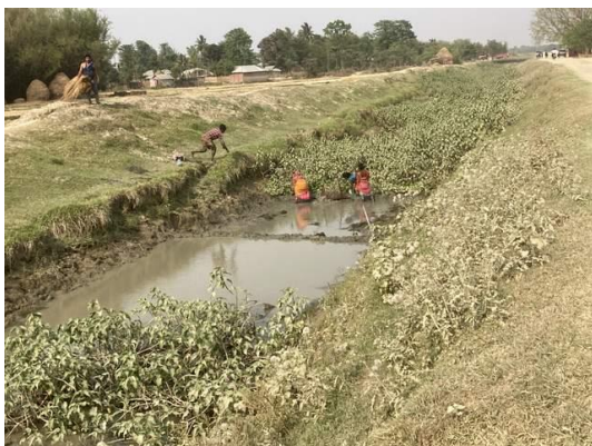
幹線用水路(中間付近): 地下水が幹線用水路表面に現れている。植生の繁茂が著しい。
