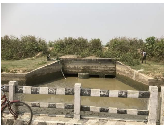
横断排水工(CDW-02) : アウトレット側から望む。幹線用水路からの漏水が、写真のように現れる。また、排水路整備が十分でないことから、常時湛水している。
