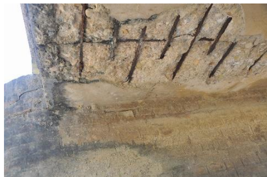
左の橋梁の頂版を下面から撮影。コンクリートが剥離し、鉄筋が露出している。
