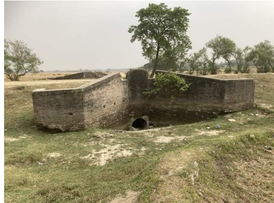
横断排水工 (CDW-11) : インレット側から望む。WUAからの補修要望があるものの、ウイングクラック以外、深刻な状況は確認されなかった。しかし、洪水の通水能力が不足していることが、洪水解析から判明した。
