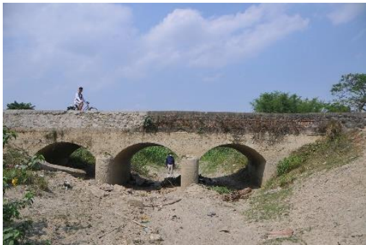
灌漑施設の当初整備された橋梁は、レンガ造りである。老朽化に伴いクラック(亀裂)が発生し、多くの橋梁は改修が必要である。
