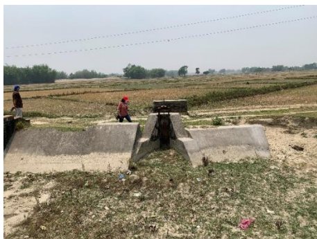
最下流地区にあるBanauli支線水路の中流部の分土工（分水ゲートが設置されている）
