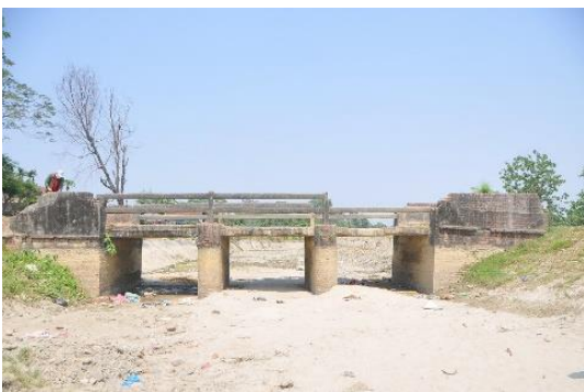
コンクリートで整備された橋梁であるが、特に頂版の劣化が著しく(写真右)、コンクリートが剥離して、露出した鉄筋が錆びている。
