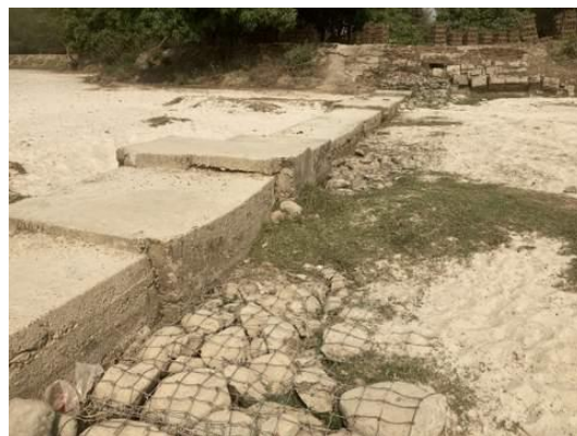
用水路サイホン(CUP7) : 幹線用水路下流側に設置されたサイホンである。カルバート部が露出しており、河川の洗堀が起きている。
