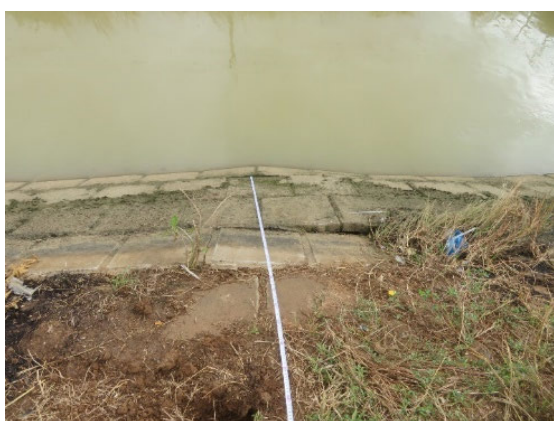
Pic-5 被覆コンクリートブロックの変状
