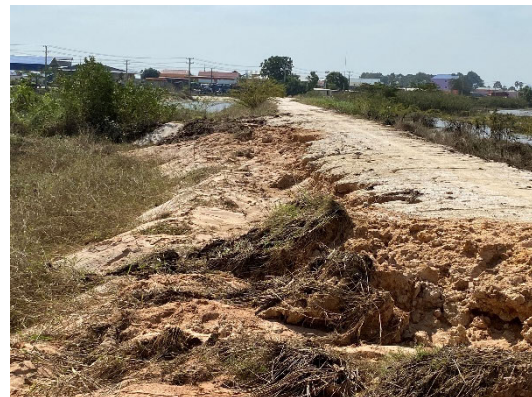
Pic-10 管理用道路の法肩の崩壊
