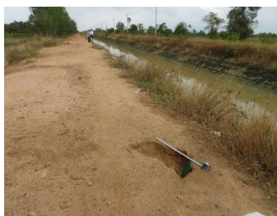
Pic-6 管理用道路の路面陥没
