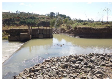
Figure 5 Seuil permanent en béton armé partiellement détruit (Région Vakinankaratra)
