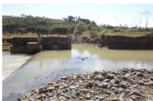
Figure 6.5.4 Seuil permanent en béton armé partiellement détruit (Région Vakinankaratra)
