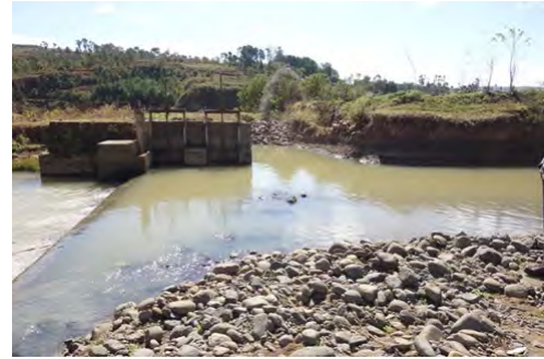
図 6.5.4 一部倒壊している鉄筋コンクリート製の恒久堰（ヴァキナカラチャ県）
