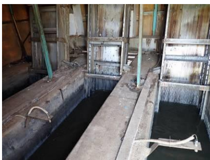
自動除塵機（沈砂設備）
