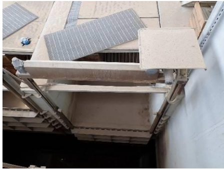
紫外線殺菌装置（ポンプ場内、メンテナンス中）
