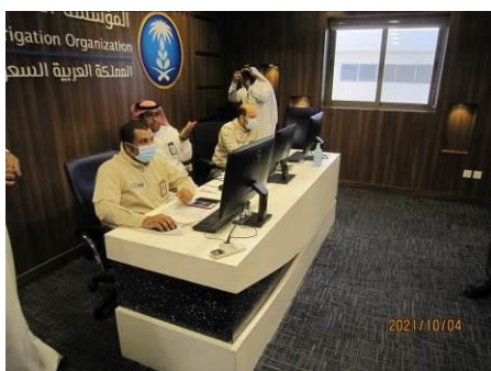
写真 4-14 : アルハサ地区再生水送付コントロール室
