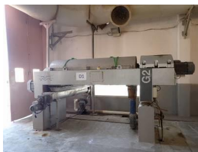
汚泥脱水機（汚泥処理設備）
