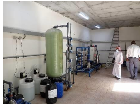
脱塩装置（農場試験場内）
