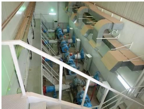
送水ポンプ設備
