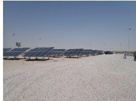
太陽光パネル（送水ポンプの動力源）
