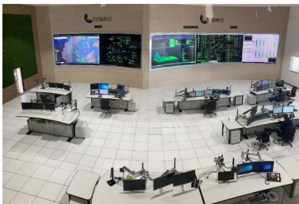
Fuente: Foto tomada por el equipo de estudio de JICA Figura 5-34 Centro de control del ONE-CENACE
