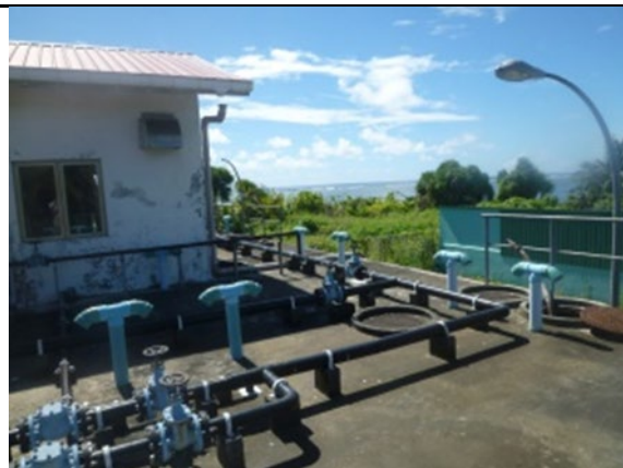
L. Fonadhoo 島下水処理場・二次処理施設上部
