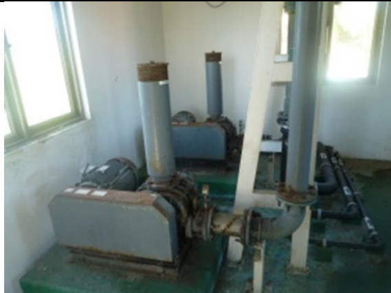
L. Fonadhoo 島下水処理場・ポンプ施設
