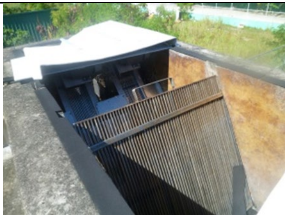
L. Fonadhoo 島下水処理場・スクリーン施設
