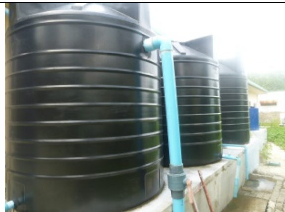
K. Hurra 島浄水場・原水処理（沈殿）タンク
