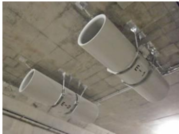
排煙設備（ジェットファン）
