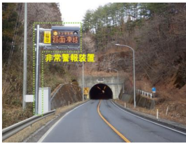
非常警報装置
