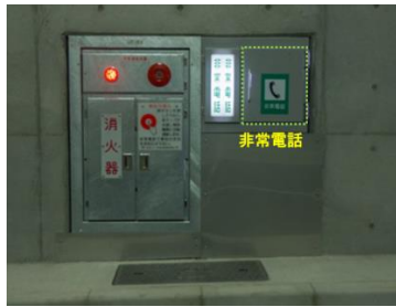
非常用電話（壁面設置）
