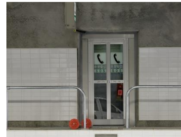
非常電話（BOX タイプ）
