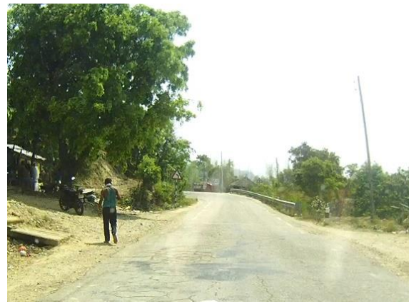
悪い（亀甲ひび割れ、ポットホール）
