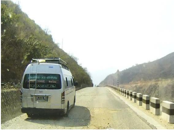
通常（クラック、部分的表層剥離）
