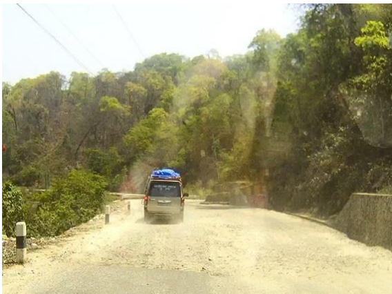
非常に悪い（舗装流出、路盤露出）
