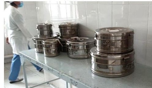
カルマナ地区中央病院 中央滅菌室
