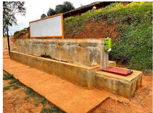
写真4.水道(Water Supply)
