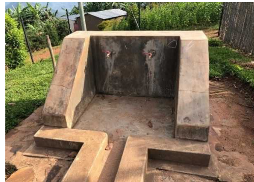
写真4.水道(Water Supply)
