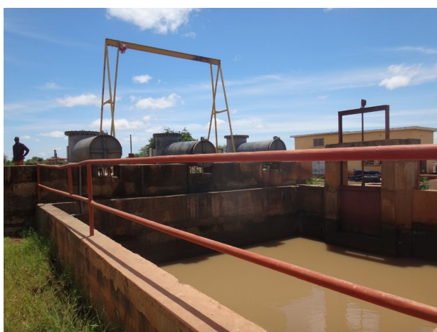
Installation d'irrigation Région de Matam
