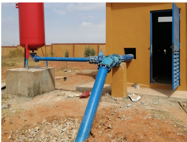
Stations de pompage et réservoirs surélevés Linguère, Région de Louga
