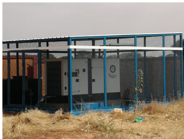
Groupe électrogène pour l'installation d'alimentation en eau Linguère, Région de Louga
