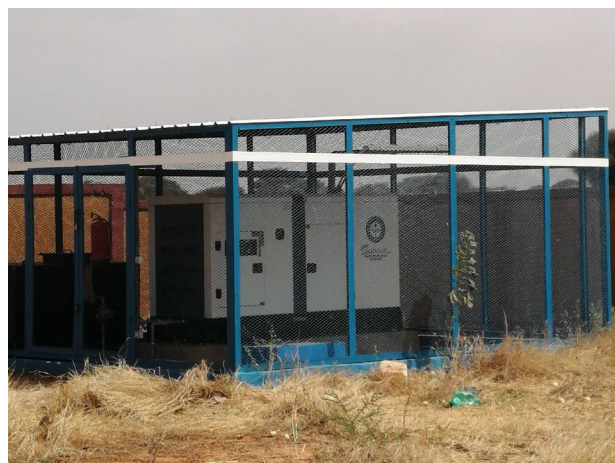
ルーガ州リンゲール 給水施設に設置される自家発電機
