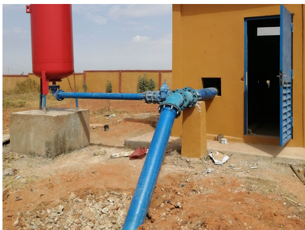
ルーガ州リンゲール 高架水槽への給水施設
