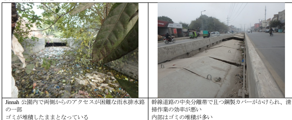
図 6.3-9 清掃が困難な雨水排水路
