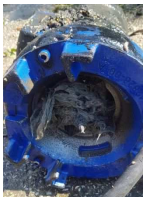
ウェットティッシュによるポンプ閉塞
