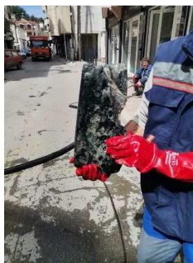
マンホール内に投棄されたコンクリート塊
