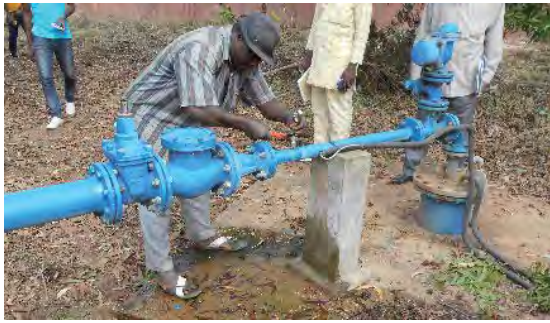
既存井戸ポンプ設備（サケテ）
