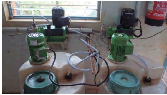
井戸ポンプ管理棟内の塩素注入設備（サケテ）
