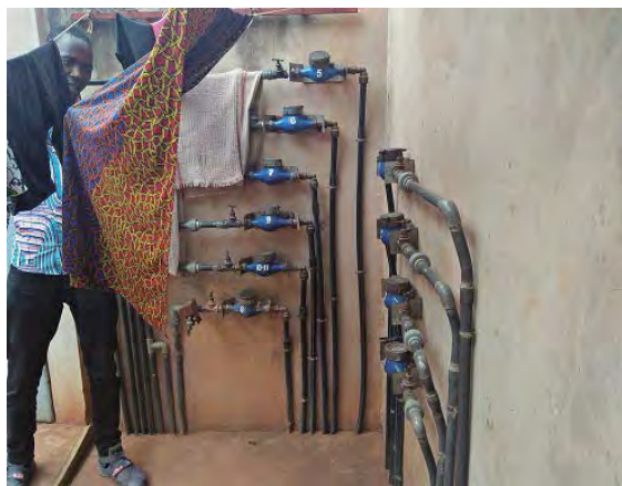
SONEB 給水栓 (アゾベ市街地)
