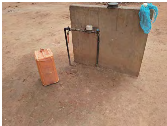
庭先に設置された給水栓 (ジャコトメ市街地)
