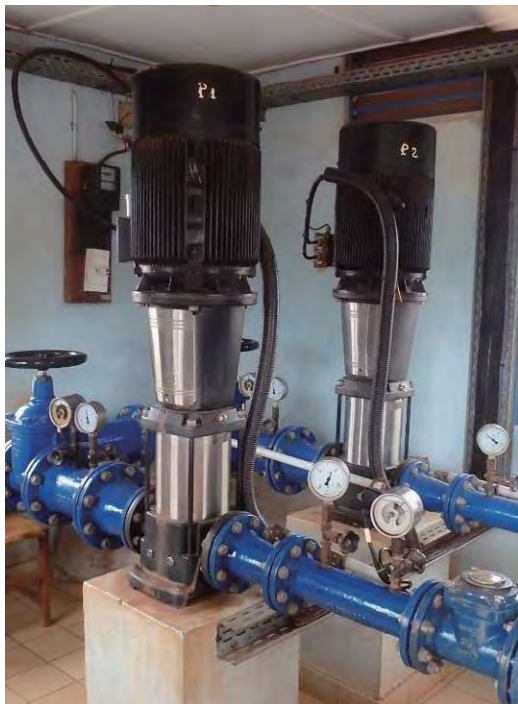
既存の中継ポンプ（ジャコトメ）
