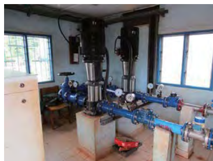
管理棟内の中継ポンプ（ジャコトメ）
