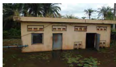
浸水している井戸管理棟（ドボ）
