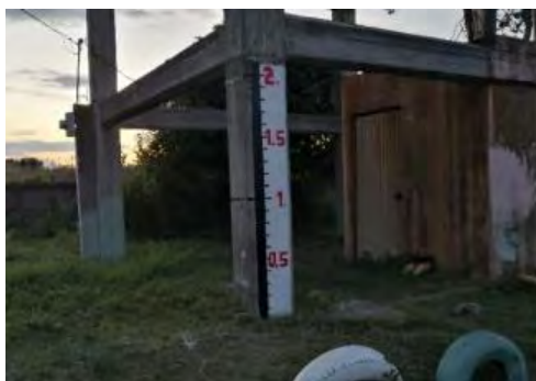
En la torre de agua de Villa Guadalupe, se instaló la escala hidrométrica en dos (2) lugares para que sean visibles desde diferentes direcciones.
